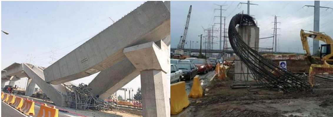
Caída de ballenas tren México –Toluca (Imagen izquierda) – Doblamiento de varillas columnas de soporte (Imagen derecha)
