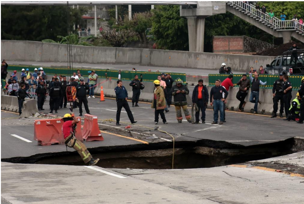
Socavón en paso exprés Cuernavaca Fotografía obtenida de http://www.excelsior.com.mx
