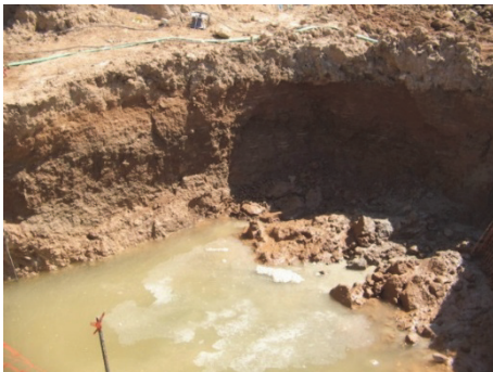
Figura 21. Inestabilidad de las paredes. Fuente: http://www.elblogdeapa.com/
