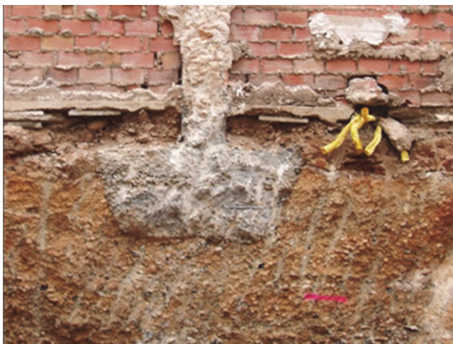
Figura 2. Descalce de una cimentación vecina durante la excavación. Imagen: E. Valiente
