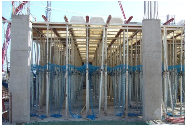
Fig. 3.2 Sistema Alucubetas (edificio de Bellas Artes, Valencia)
