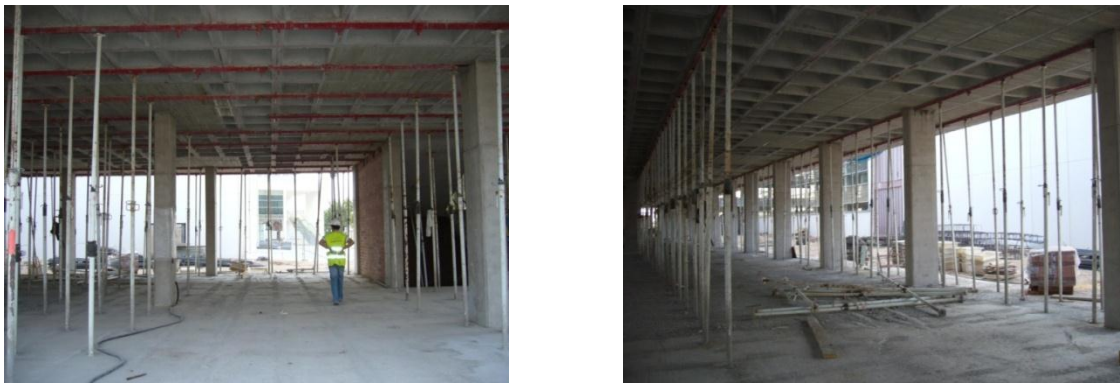
Fig. 4.39 Operación no controlada realizada antes del Clareado del Forjado 3
