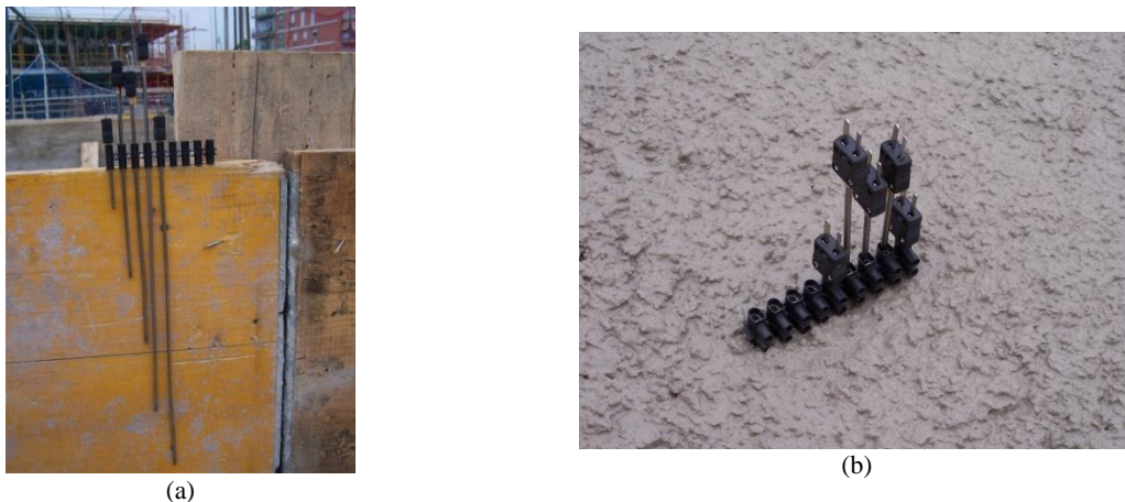
Fig. 3.8 Termopares tipo J (a) Termopares con conector mini tipo J (b) Termopares embebidos en el hormigón
