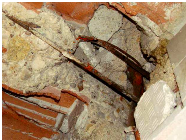
Figura IV. 119. Viga interrumpida por paso de instalaciones, INTEMAC, 1964
