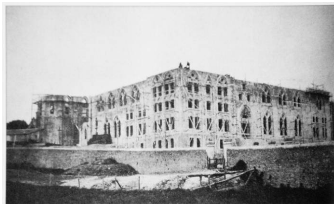
Figura I. 22. Obras del monasterio de Viaceli en Cóbreces (Cantabria) 1907. Salvador Oller y Federico Ugalde, arquitectos. Construido por la Soci t  des Ciments Portland de Sestao.
