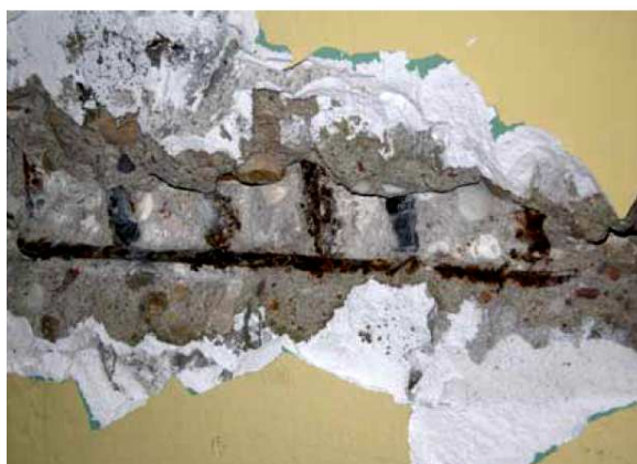
Figura IV. 137. Cala de viga en centro de vano. Edificio ficha 94C.023, 1966.
