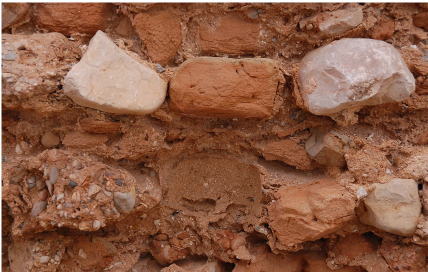
Fig. 294. Detalle de cuadro patológico frecuente entre núcleo de relleno de las fábricas y estratos de mampuestos. (Ruiz Checa)
