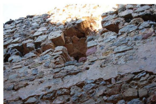
pérdida de forjados
