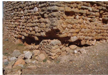
perdida de material en las esquinas
