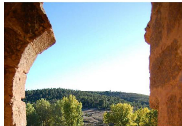
perdida de material en los vanos
