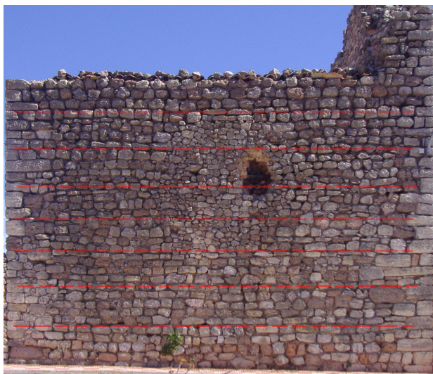
Fig. 276. Detalle del alzado suroeste de la torre de Solera donde, a pesar de la intervención a posteriori en la zona del vano, se aprecian las hiladas de las posibles jornadas de trabajo ( Ruiz Checa)
