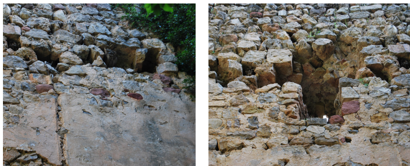
Fig. 269. Detalle de mechinales en la torre Barrachina, para determinar las dimensiones de las escuadrías de maderas empleadas (Ruiz Checa)
