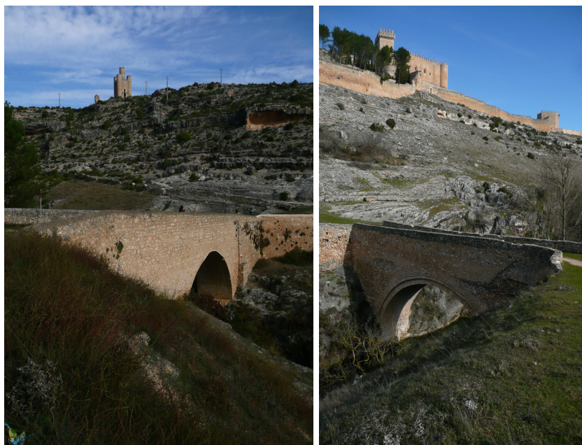
Fig.106. Puentes históricos en el ámbito de estudio, vinculados con milenarias arterias de comunicación: puente de Tébar y de El Picazo en Alarcón (Ruiz Checa)
