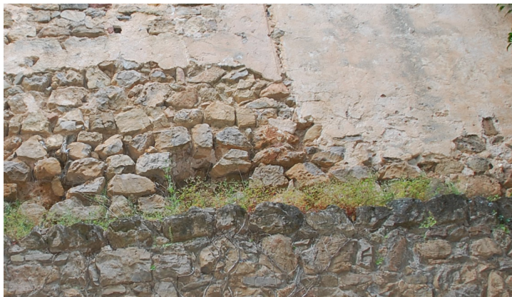
Fig. 278. Huellas de niveles de forjados y tabiquerías en las trazas de enlucidos torre Barrchina (Ruiz Checa)
