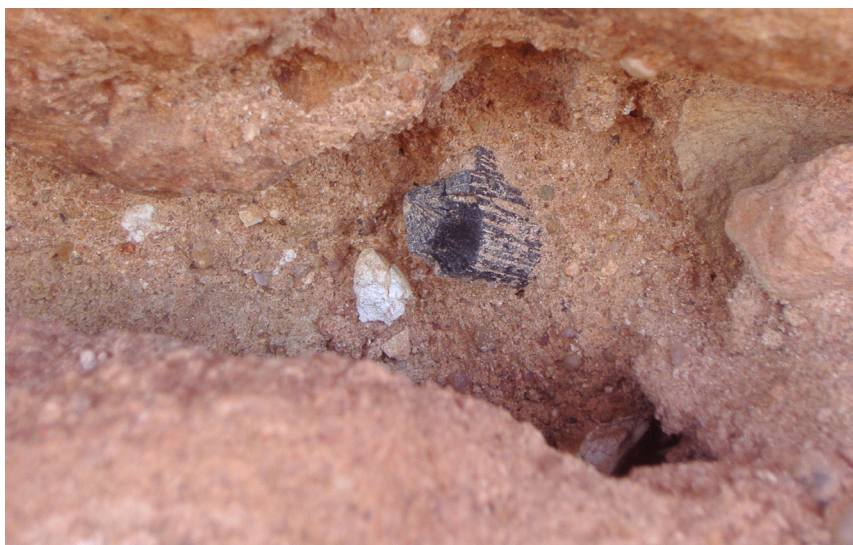
Fig. 288. Detalle de fábricas: vacíos entre las capas de rellenos del núcleo Torre de Valhermoso (Ruiz Checa) Detalle de fábricas: caliches y huellas de carbón en la elaboración de morteros, Torre de Valhermoso (Ruiz Checa)
