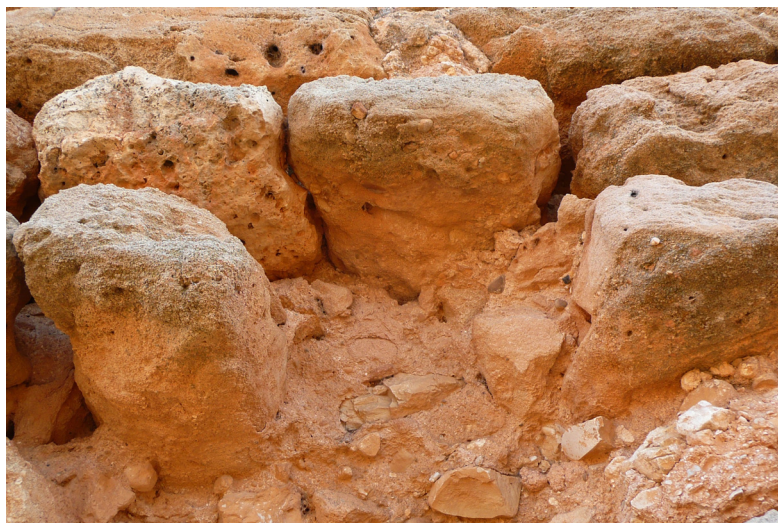
Fig. 281. Detalle de los mampuestos y relleno del núcleo de argamasa en las fábricas analizadas. (Ruiz Checa)
