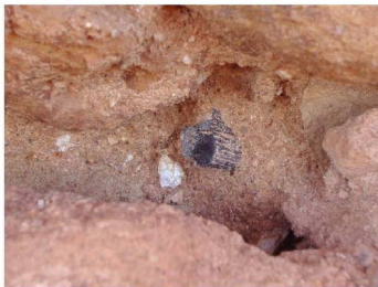
eflorescencias y pulverización de mortero
