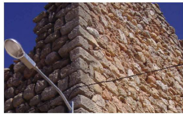
presencia de instalaciones conflictivas
