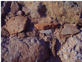
perdida de juntas estructurales
