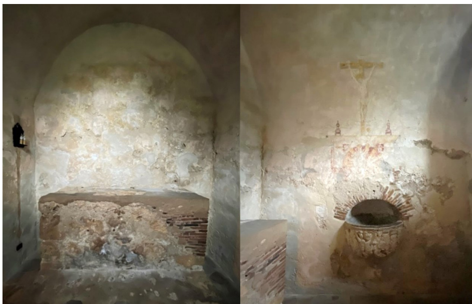
Figura 2. Interior de la sala del baptisteri mostrant el fresc i la deterioració de les parets
