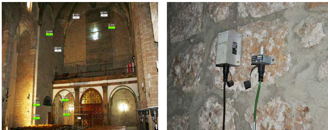
Fig. V.45. Disposición general de los sensores y detalle de un inclinómetro y un termómetro.
