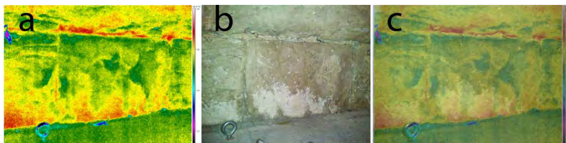
Fig. V.179. Sillar con eflorescencias, (a) termografía, (b) foto y (c) superposición de (a) y (b).
