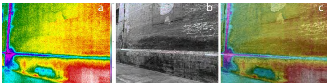
Fig. V.171. Ascensión del agua por capilaridad vista (a) con la cámara termográfica, (b) fotografía y (c) superposición de (a) y (b).
