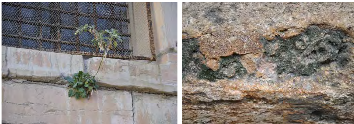
Fig. V.127. Ejemplos de biodeterioro.
