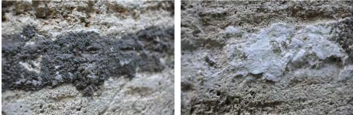
Fig. V.35. Enmugrecimiento en las juntas entre los sillares del zócalo en el Colegio del Patriarca.
