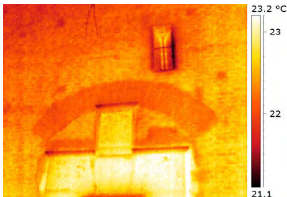
Fig. V.156. Termografía de la fachada oeste.
