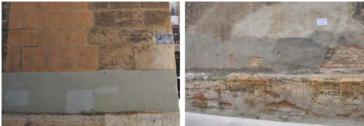
Fig. V.120. Enfoscados o pinturas que ocultan otros materiales.
