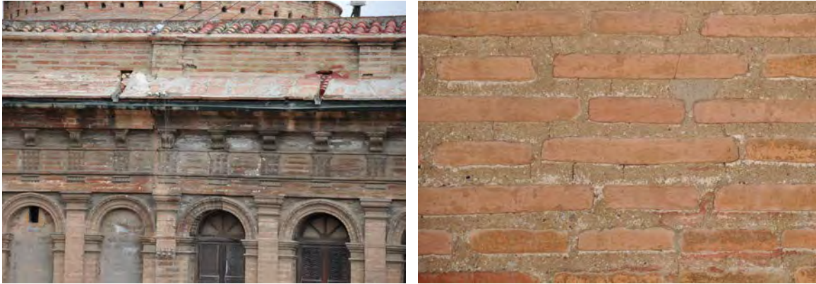
Fig. V.133. Ejemplos de eflorescencias.
