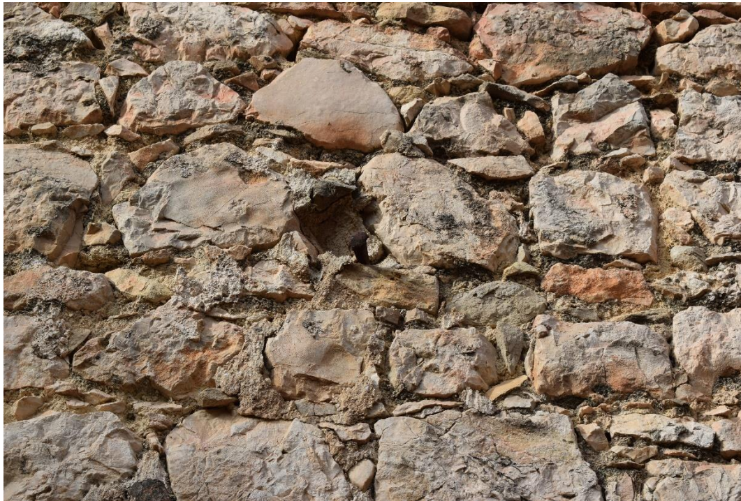
FIGURA 15. Fotografía de detalle de la composición de sillarejo de los paramentos. Fotografía de Autor.
