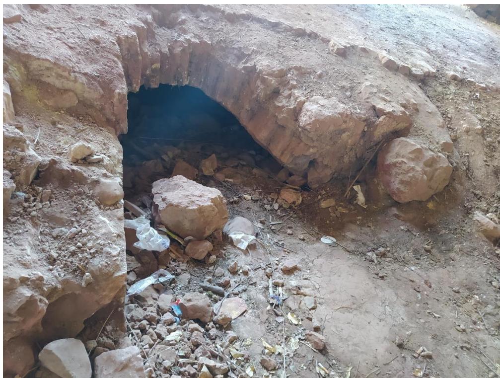
FIGURA 23. Fotografía del Cárcavo colapsado de escombros. Fotografía de Autor.
