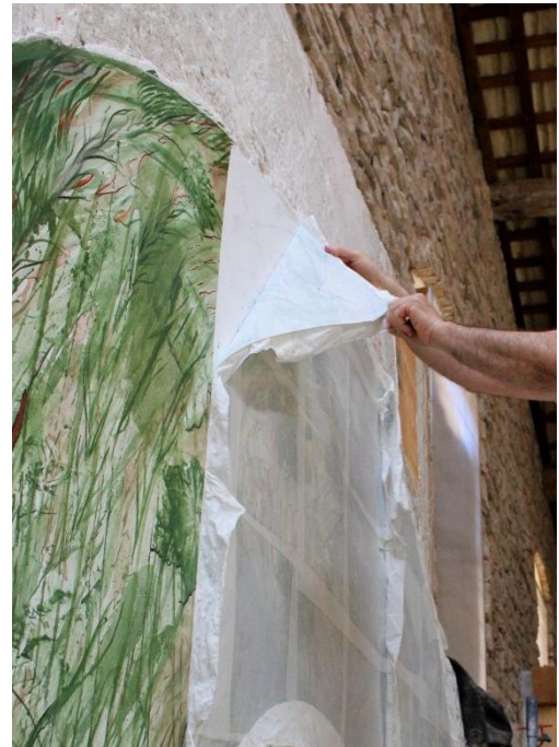
Figura 9. Proceso de separación y desprendimiento de la pintura del muro. Fuente: Minguell i Cardenyes, 2021.
