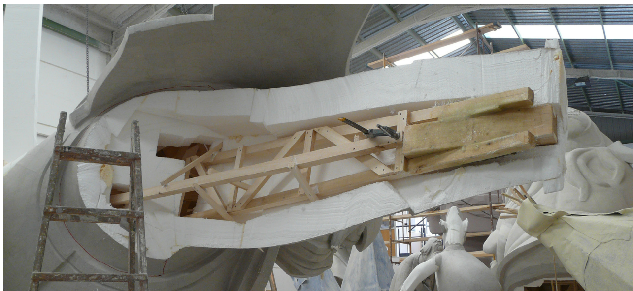
Proceso de ensamblaje de la estructura con el volumen de poliestireno expandido empapelado. Fig 2.1
