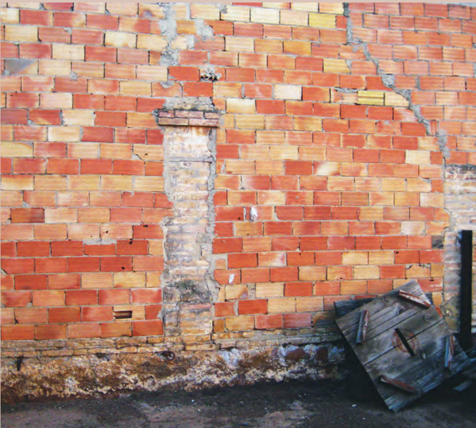
Fig. 22. Pilastras originales del muro Sur del patio de la Casa dels Bous , actualmente recrecido con ladrillo hueco. Fotografía de Andrea Peiró Vitoria.
