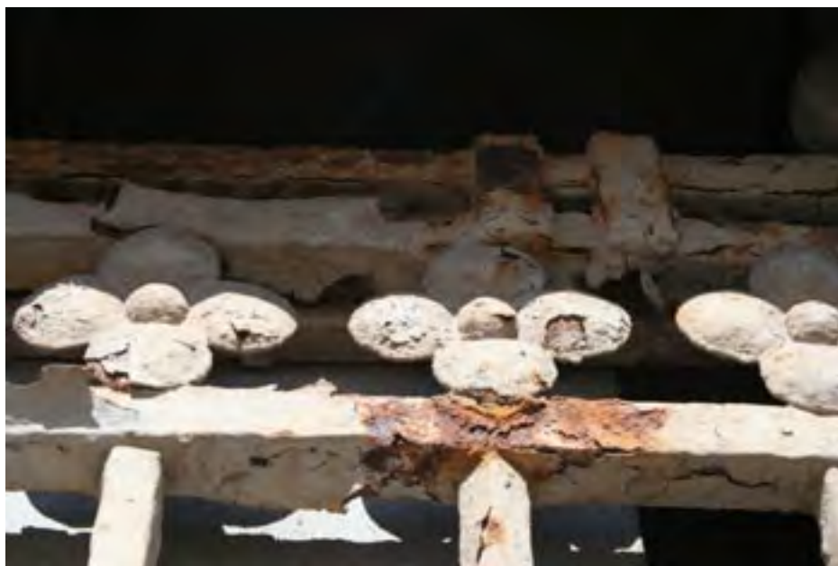
Fig. 5. Corrosión acentuada con laminación y pérdida material en numerosos elementos decorativos de las verjas metálicas.
