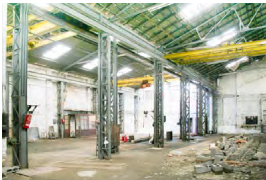
Fig. 9. Interior de las naves oriental y central de la Fábrica del Hielo
