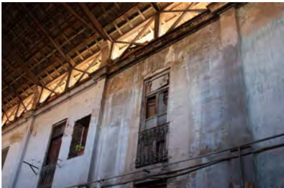
Fig. 10. Filtraciones de agua en las fachadas del patio interior por fallos en las canalizaciones.
