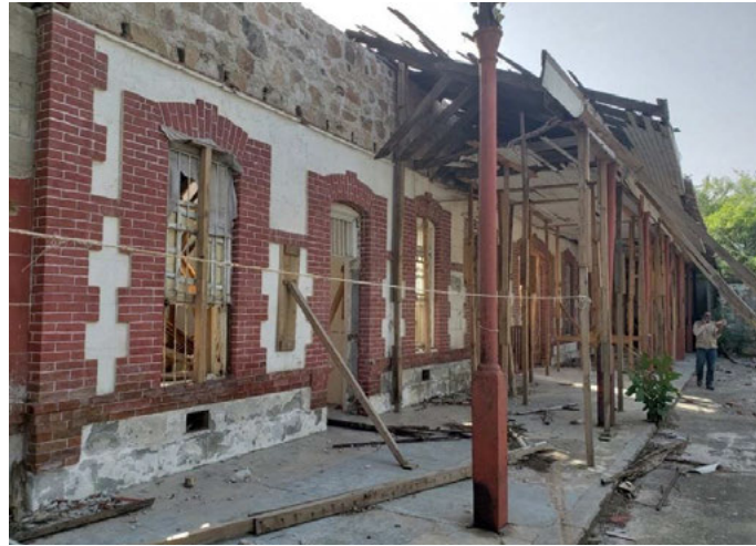
Fig. 7 Fachada principal, restos de alero perimetral. Archivo de investigación del autor (2018)
