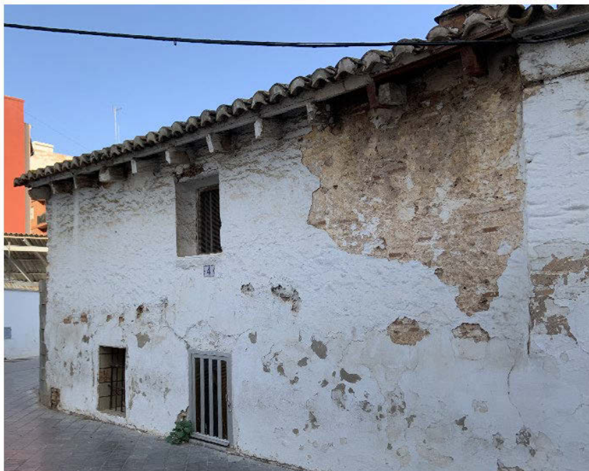
Fig. 4 Alquería en el Campanar cuyos muros están realizados con tapia careada de ladrillo. El desprendimiento del enlucido, causado por la falta de intervenciones de mantenimiento que caracterizan, en general, el edificio, permite apreciar la estructura del muro. Si bien el elemento se ha conservado, se aprecia como su entorno ha sido desvirtuado, perdiendo la identidad tradicional. Caruso, julio 2021
