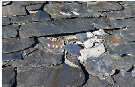
Fig. 2 Pérdida de material. Este punto en concreto se manifiesta al interior en forma de gotera
