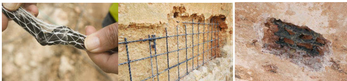
Fig. 3 Proceso de reconstrucción con hormigón de cal + malla de fibra de vidrio + fioccos de fibra de carbono. Mainel intervención arquitectura SL (2021)
