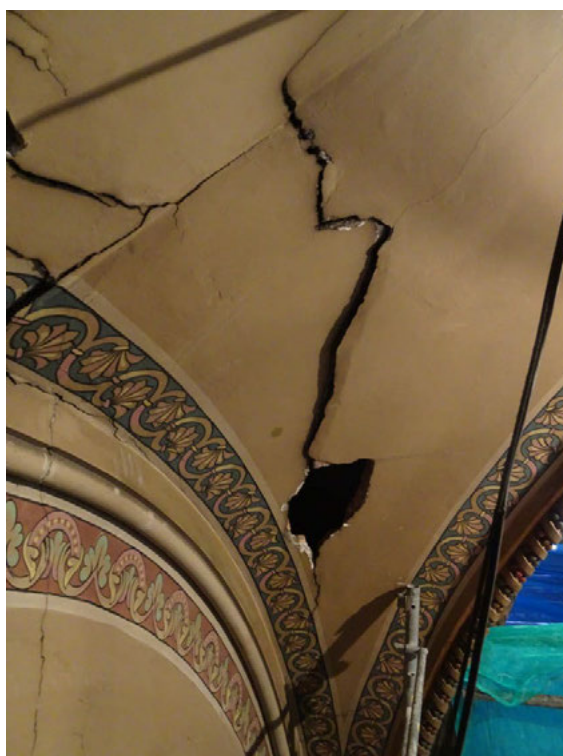
Fig. 4 Detalles de uno de los lunetos agrietados, con el agujero provocado por la caída de un trozo de bóveda (2020). ARAE Patrimonio y Restauración SLP
