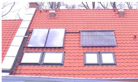
Figura 6. Captador plano y de tubos de vacío en el techo del edificio del Instituto de Construcción en Olsztyn.
