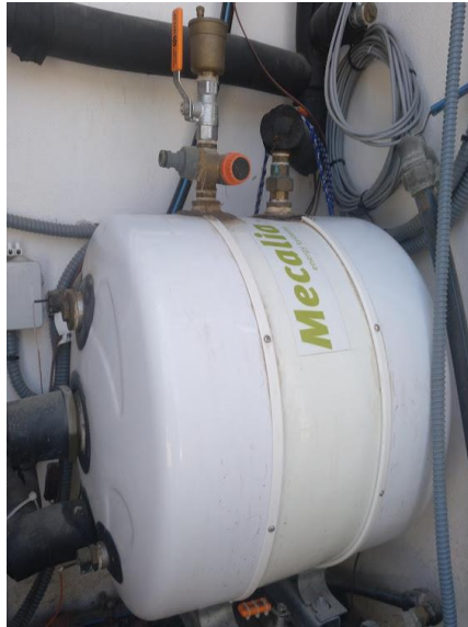
Figura 18. Depósito de inercia.
