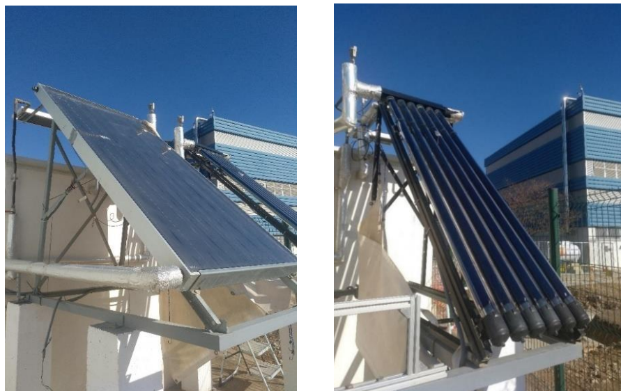
Figura 12. Fotografía del captador solar plano y del captador de tubos de vacío.
