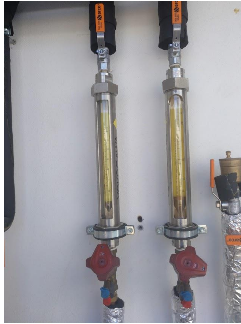
Figura 16. Rotámetros regulables “Yokogawa” a la entrada de cada uno de los captadores solares.
