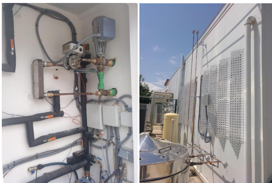
Figura 31. Instalación caudalímetro volumétrico en circuito primario y circuito hidráulico del depósito.
