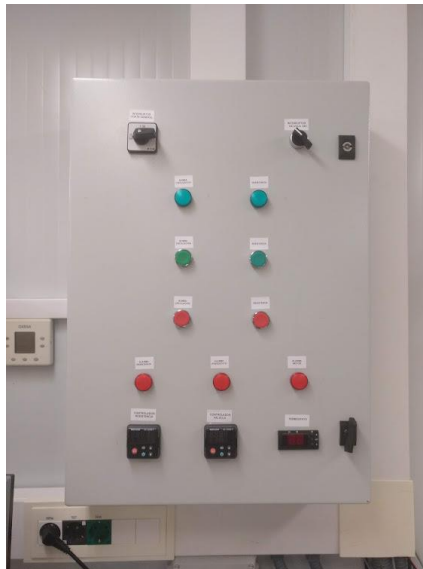
Figura 24. Cuadro eléctrico de control.
