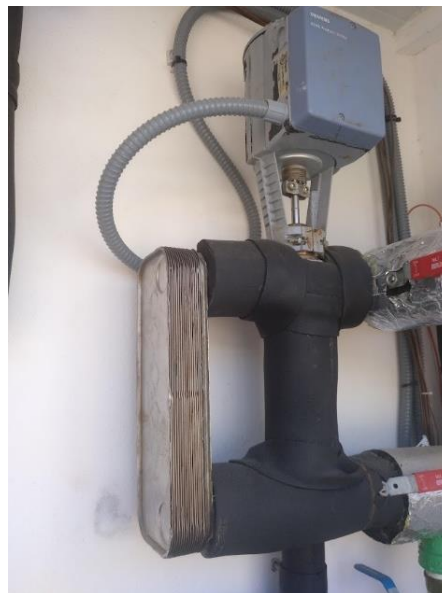
Figura 17. Intercambiador de placas “AlfaLaval CB26-16” y válvula de tres vías.
