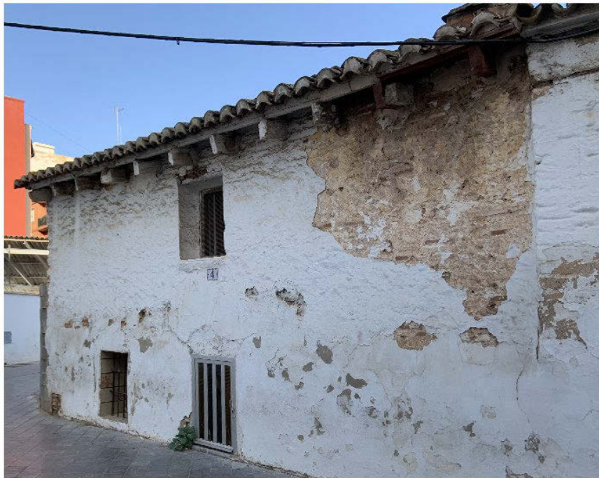
Fig. 4 Alquería en el Campanar cuyos muros están realizados con tapia careada de ladrillo. El desprendimiento del enlucido, causado por la falta de intervenciones de mantenimiento que caracterizan, en general, el edificio, permite apreciar la estructura del muro. Si bien el elemento se ha conservado, se aprecia como su entorno ha sido desvirtuado, perdiendo la identidad tradicional . Caruso, julio 2021
