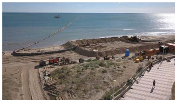
Fig. 8 Vista general de los equipos del tren de dragado
