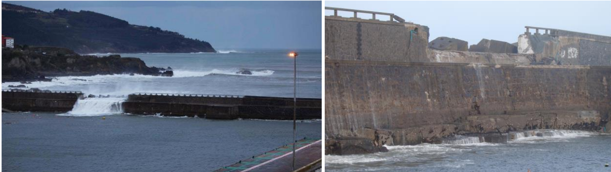
Fig. 5 Rotura del espaldón durante el temporal del 9 de febrero de 2016. Fuente: TYPSA (2016)
