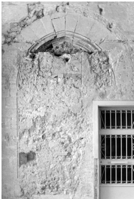
Estado previo del Arco de la iglesia de San Agustín
