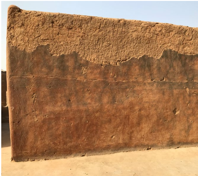
Desprendimiento del enlucido inciso y pintado en una casa de la Corte Real de Tiebelé, probablemente por la humedad de la lluvia.
