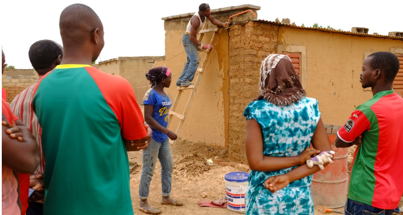
Reparación de viviendas durante el proyecto de mejora del barrio de Boassa.
