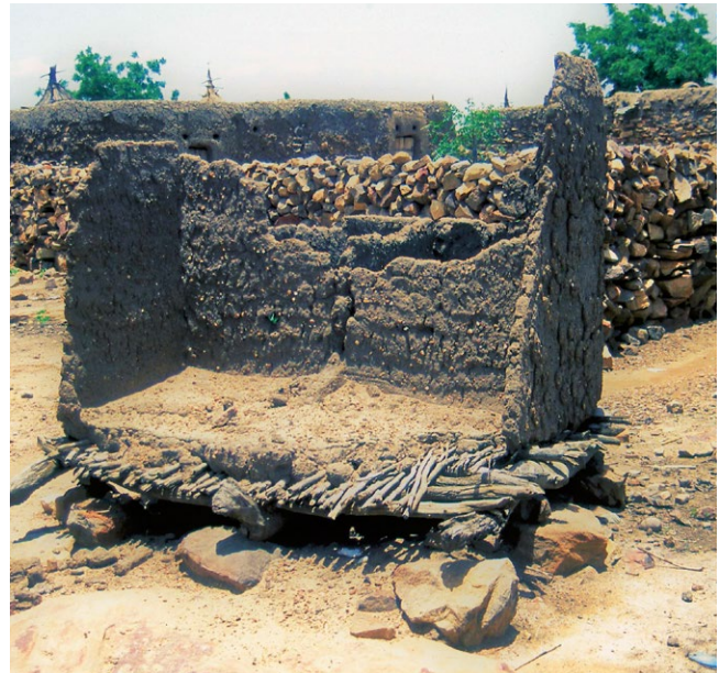
Silo dogón semiderruido por falta de atención y reparaciones que permite observar perfectamente su sección constructiva.
