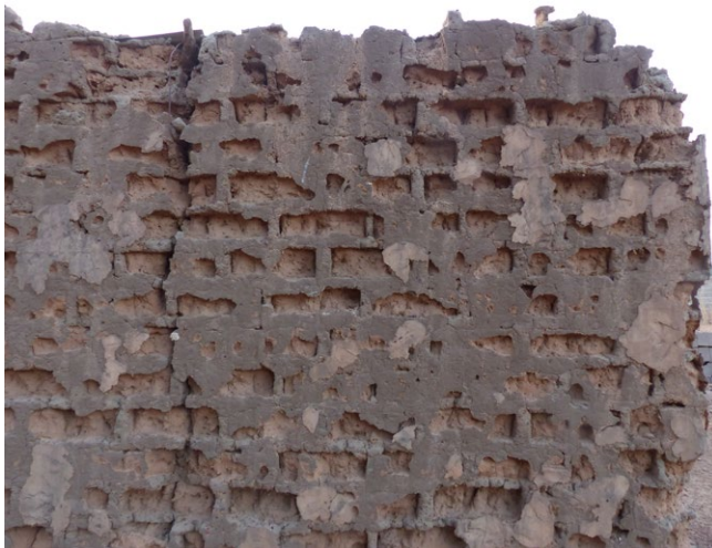
Juntas y enlucido de mortero de cemento sobre el muro de adobes que está consumiendo paulatinamente el cuerpo del muro construido con tierra, por incompatibilidad entre ambos.
