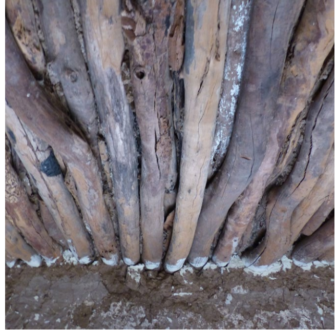
Rollizos de madera sin desbastar empleados como viguetas apretadas entre sí para soportar el peso del grueso estrato de tierra que conforma la cubierta plana en una vivienda bobo.
