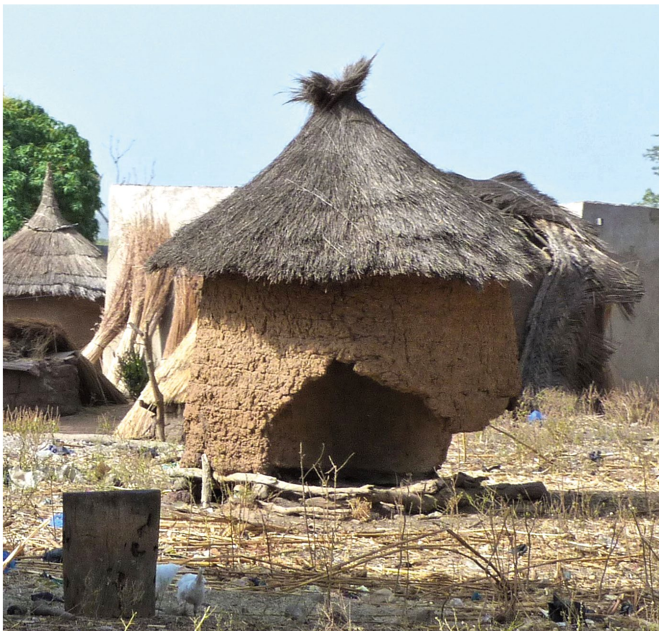
Boquete en una choza de paredes de tierra en un poblado gan provocado por un colapso, probablemente debido a exceso de humedad.
