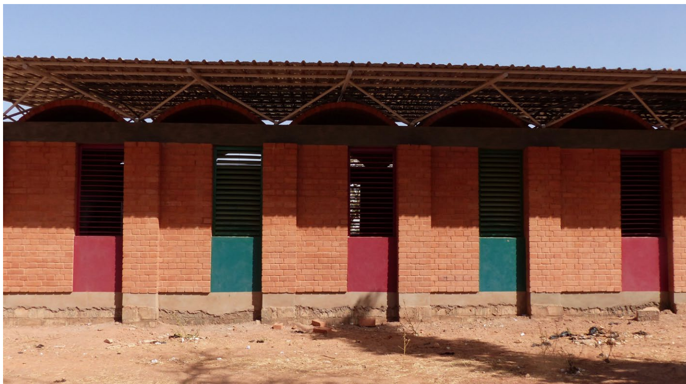
Aulario de la escuela, construido durante la Fase 1 del proyecto, a falta del podio del edificio.
