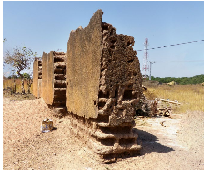
Un caso similar al anterior con una mayor afección a la zonas más bajas del muro.
