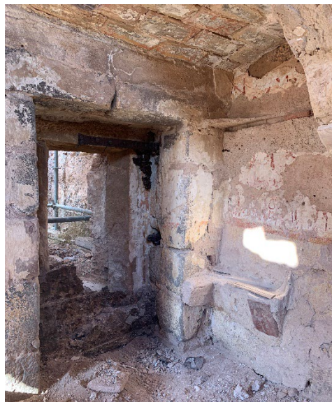
Fig. 7- La sala noreste tras la excavación arqueológica. Se aprecian las pinturas murales y los restos de la puerta del calabozo (Autores: Vegas y Mileto).
