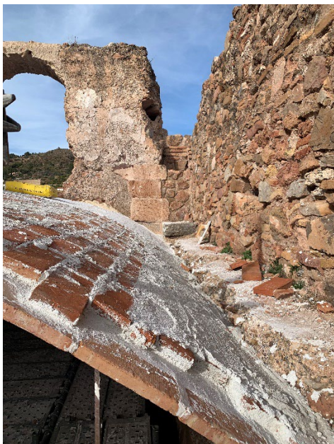
Fig. 10- Construcción de la bóveda tabicada en la sala este. En la imagen se aprecian las dos capas de ladrillos con las que se conforma la bóveda (Autores: Vegas y Mileto).
