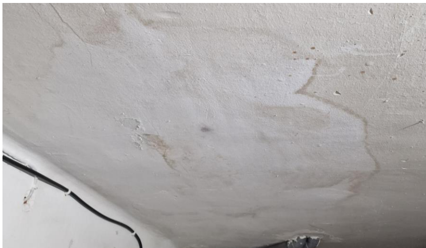
Figura 53. Humedad por filtración. 2024. Fuente: Propia
