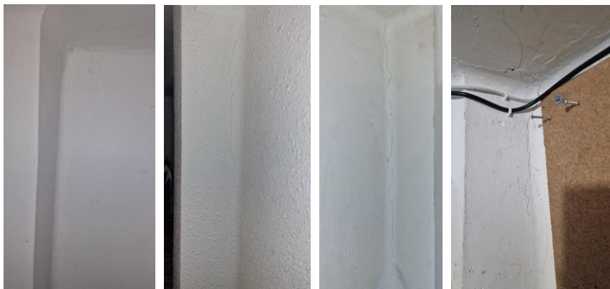
Figura 54. Humedad por capilaridad. 2024. Fuente: Propia
