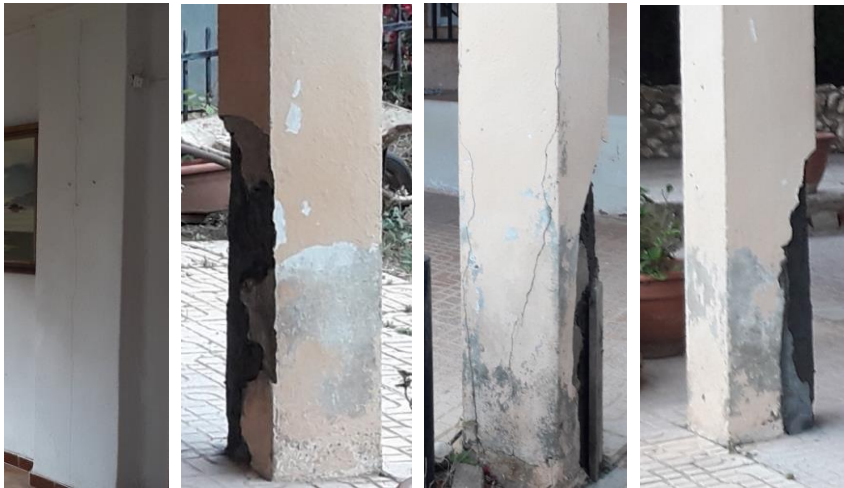
Figura 51. Lesiones en pilares. 2024. Fuente: Propia
