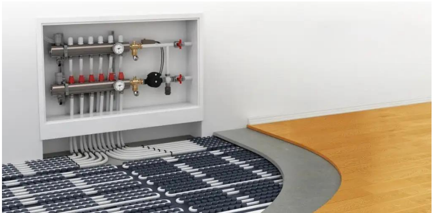
Figura 81. Suelo radiante. 2024. Fuente: activaenergiasrenovables.com
