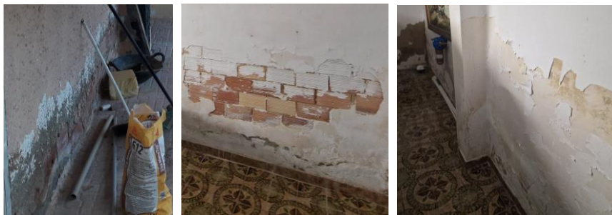
Figura 52. Humedad por capilaridad. 2024. Fuente: Propia
