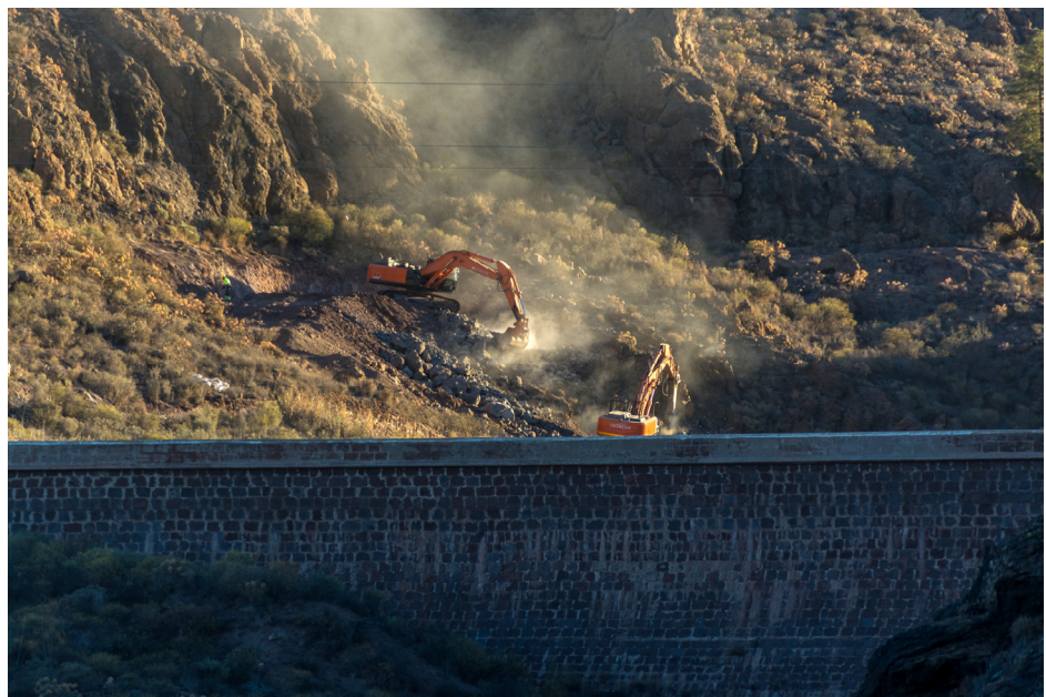
Fig. 15. Torres 2024. Maquinaria y comienzo de las obras en la Presa de Chira, Gran Canaria.
