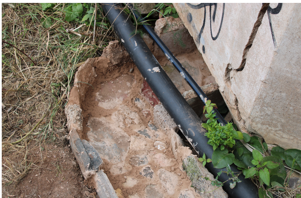
Fig. 84. Acueducto, Si llueve se va romper; si no, también.
