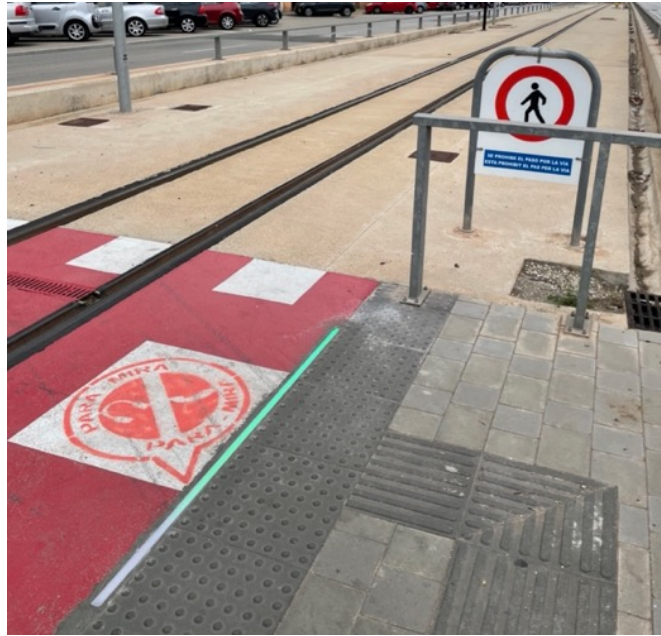
Figura 40. Vista de uno de los cruces para peatones de las vías con las tiras de luces para prevenir accidentes a peatones.
