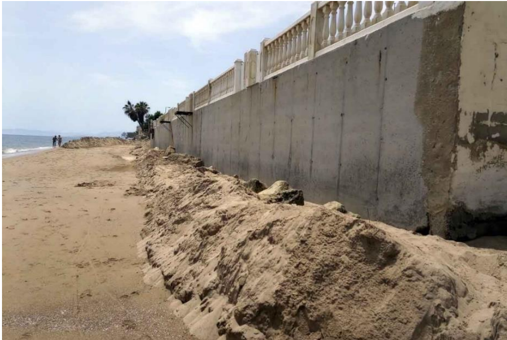
Figura 58: Tramo de playa sin apenas arena para la contención del mar frente a las viviendas en Tavernes de la Valldigna la región de La Safor (Valencia).
