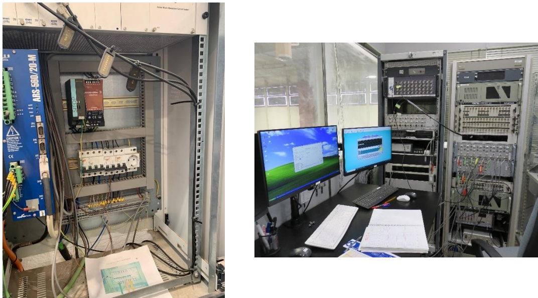
Figura 36: Equipo de generador de oleaje.
