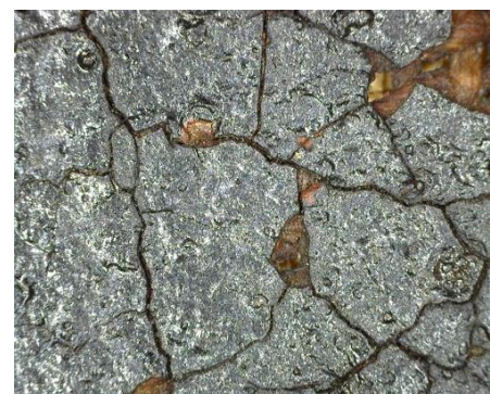
Figura 42. Fotografía de detalle de las grietas de envejecimiento.
