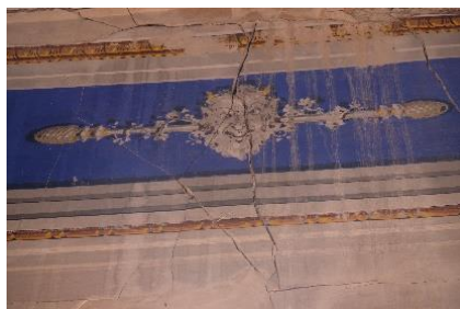
Fig. 84. Detalle grieta y manchas humedad pared sur
