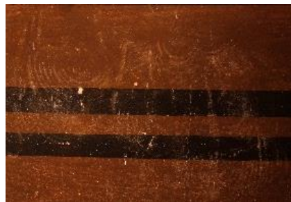
Fig. 90. Detalle manchas pared sur
