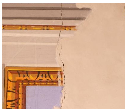
Fig. 85. Detalle grieta, manchas humedad y laguna pared oeste
