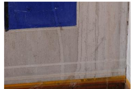
Fig. 91. Detalle polvo y manchas humedad pared oeste
