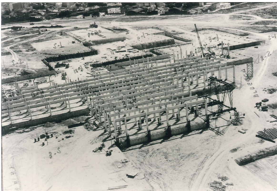
Figura 3. Proceso constructivo de la estructura de la Feria de Muestras de Valencia, 1969. Departamento Técnico y de Sistemas de la Feria de Muestras de Valencia, 2021.
