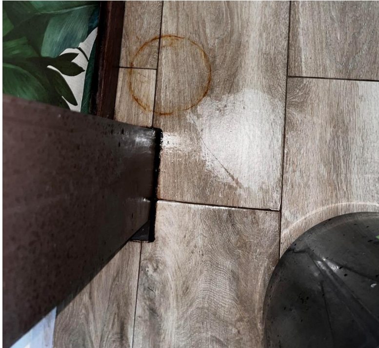
Figura 40. Demostración de filtración de agua en la columna.
