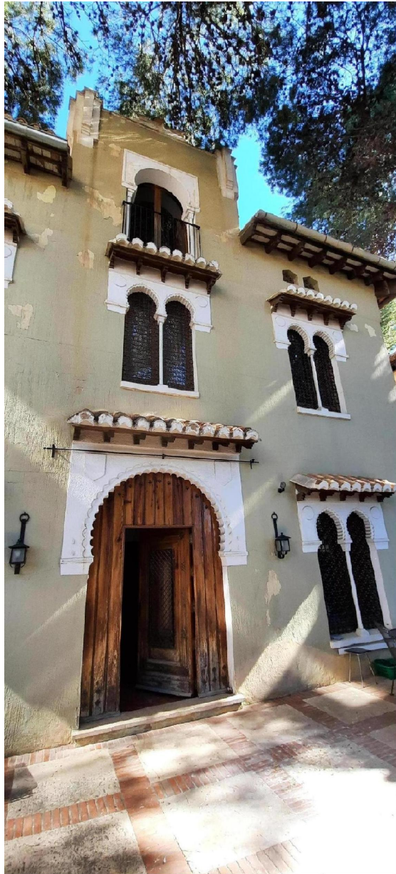
Accesibilidad. Existencia de desnivel [Ref. AC001]
