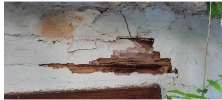
Figura 39. Dintel de madera de la puerta del trastero. Fuente propia.
