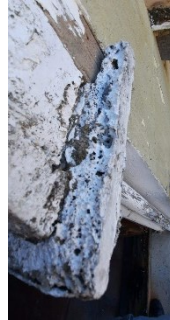
Figura 28. Molduras de yeso erosionadas. Fuente: Propia
