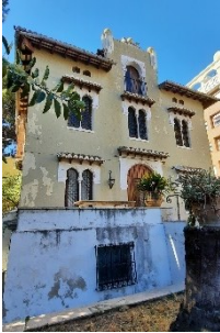
Figura 29. Visión general de la fachada afectada. Fuente: Propia
