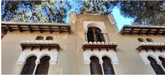
Figura 32. Fachada jardín trasero con escurriduras. Fuente propia
