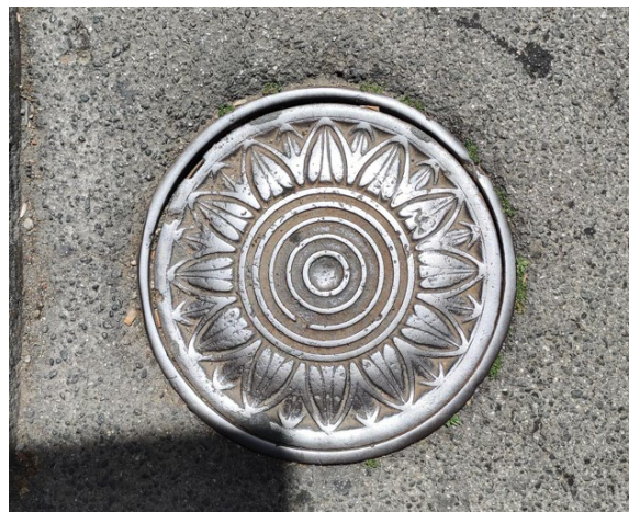
Fig. 2. Tapa de acometida de aguas residuales. Ubicación: Calle Santa Paula. Sevilla Fuente: Elaboración propia (2023)
