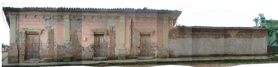
Figura 6.19. Estado de conservación de la fachada Norte de casa Galeano en el año 2004. Fuente: AECID (2004).
