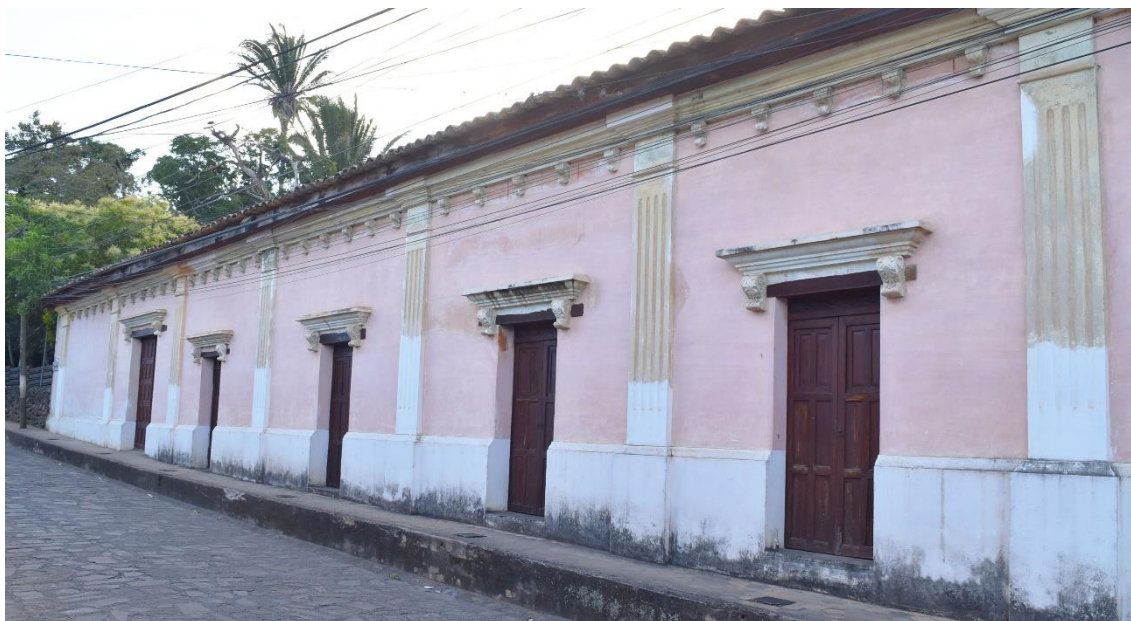
Figura 6.20. Estado de conservación de la fachada Este de casa Galeano actualmente. Autora: A. Ferrando Ortiz (enero 2024).
