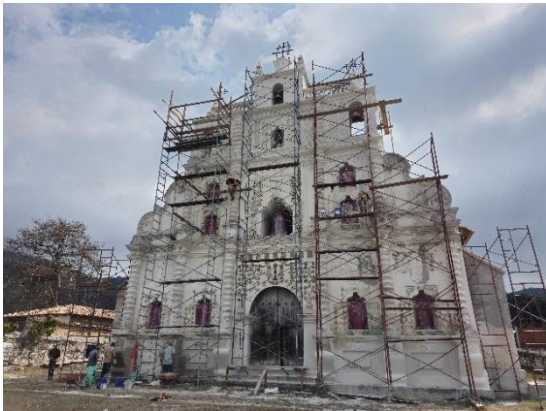
Figura 6.77. Restauración de fachada principal, armado de andamios, San Manuel de Colohete. Autor: J. E. Álvarez (diciembre 2023).
