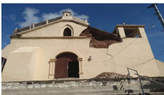
Figura 5.10. Fachada de la iglesia católica de Marale antes de su restauración. Fuente: Informe final de proyecto facilitado por la empresa constructora CONGESAHN (2022).
