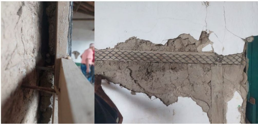
Figura 4. Intervención inadecuada de materiales para restaurar muro de Bahareque
