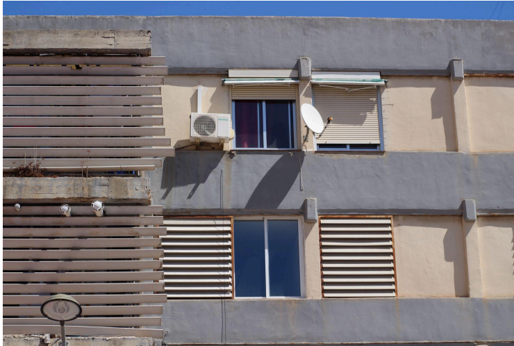
Figura 3.6. Instalaciones en fachada. Imagen de autor.
