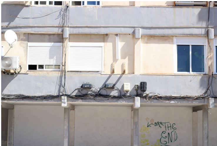
Figura 3.11. Instalación eléctrica y de telefonía vistas en fachada.
