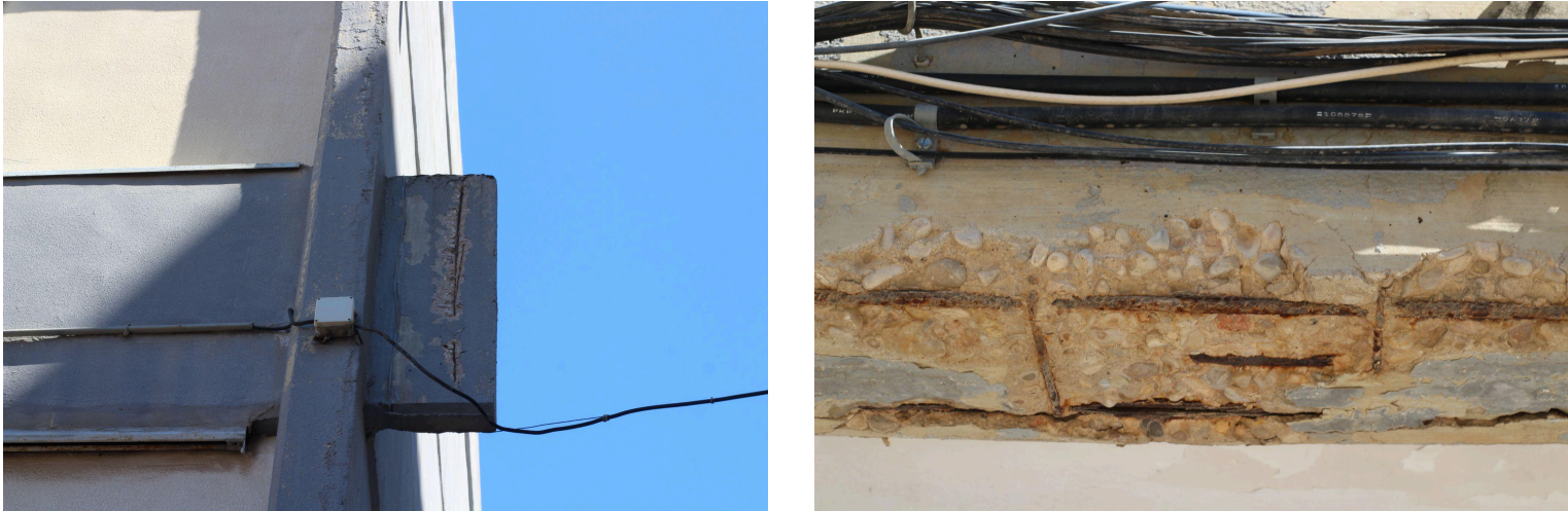
Figura 3.5. Desconchamiento del hormigón y corrosión de las armaduras. Imagen de autor.
