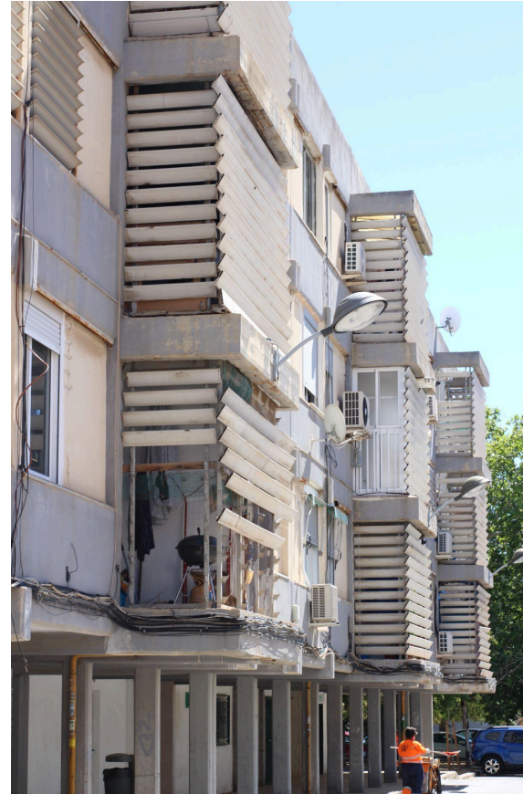
Figura 3.7. Mal estado lamas de oscurecimiento y humedades en voladizos. Imagen de autor.
