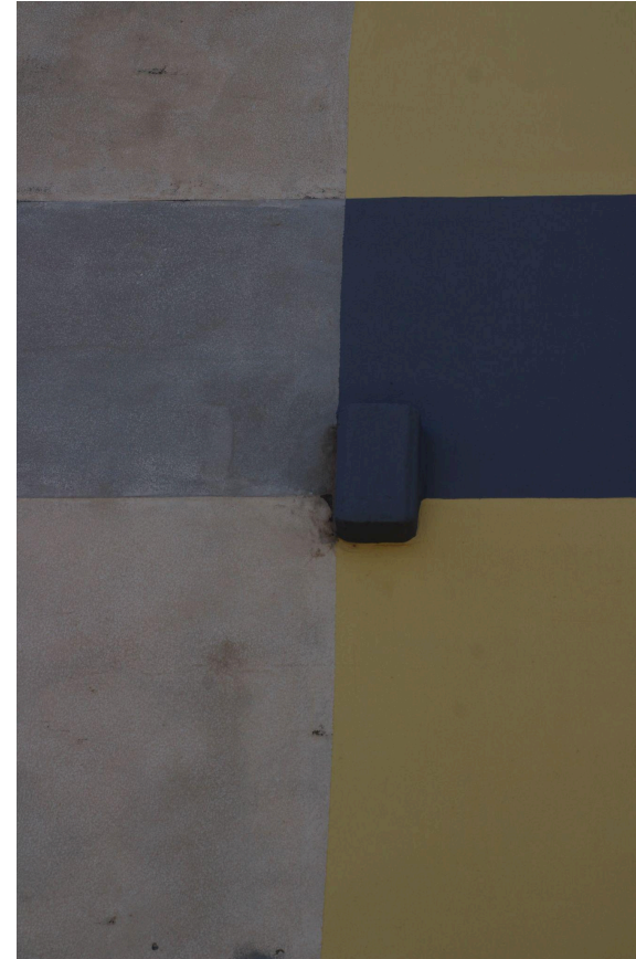
Figura 3.10. Cambios de coloración en la pintura de las fachadas.
