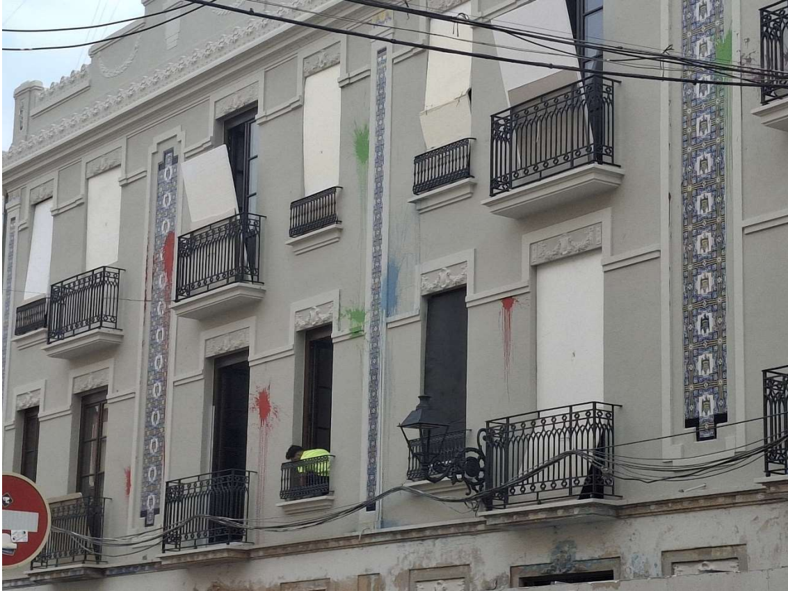
Figura 54. Fachada manchada de pintura del nuevo hotel boutique.
