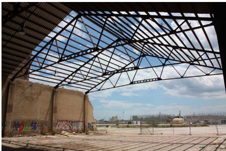
Ilustración 10.44. Estado de lo que queda de las naves (Diana Sánchez, 2010).
