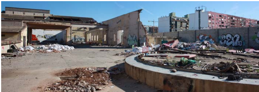
Ilustración 3.28. Degradación absoluta de las antiguas instalaciones de Cervezas El Turia de Valencia (Diana Sánchez, 2011)
