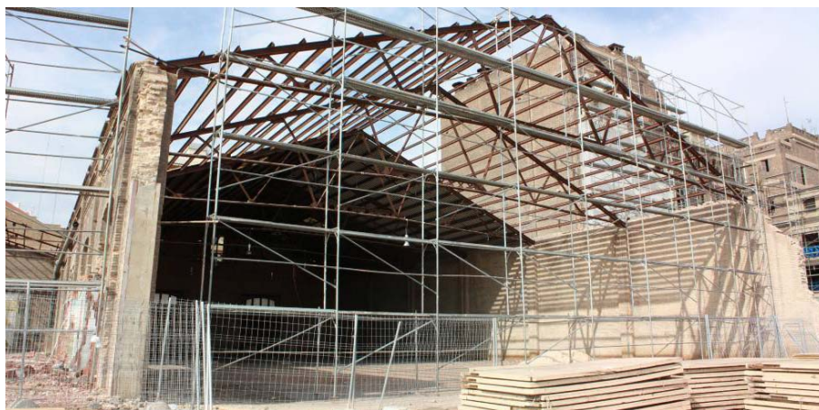
Ilustración 10.41. Estado de las naves tras eliminación de pórticos (Diana Sánchez, 2005).
