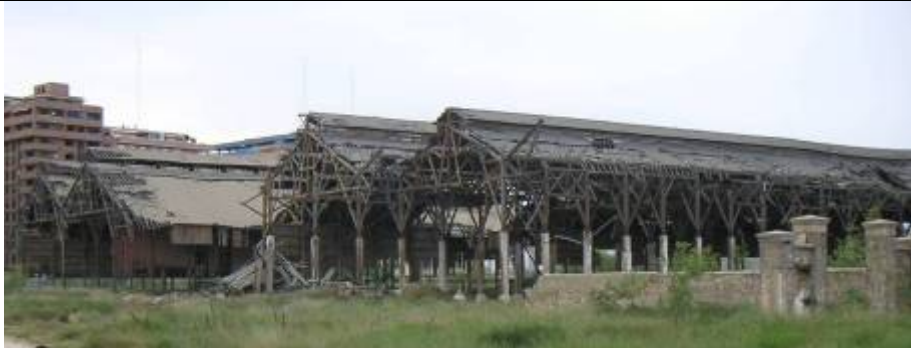
Estado de las naves, a la derecha se aprecia parte del muro original de cerraba la fábrica.
