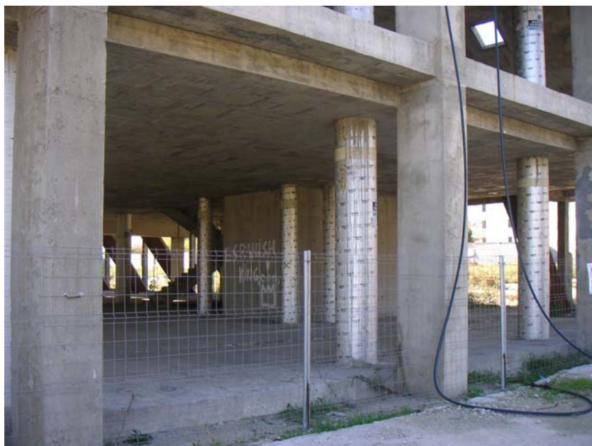
Ilustración 10.101. Vista de nave con obras paralizadas (Diana Sánchez, 2008).
