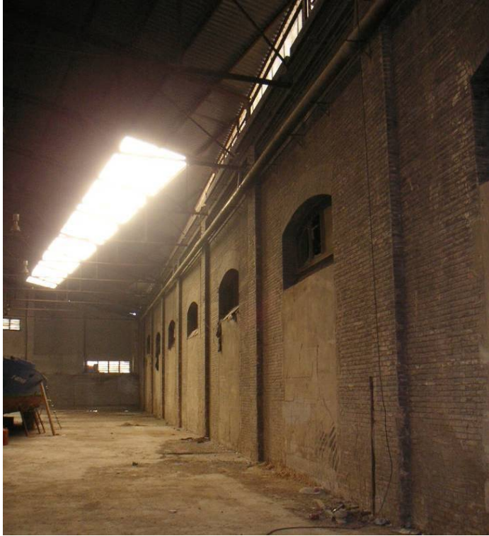
Ilustración 10.30. Una de las fachadas laterales que daban al patio original (Diana Sánchez, 2007).
