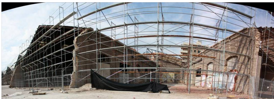
Ilustración 10.42. Estado de las naves tras eliminación de pórticos (Diana Sánchez, 2005).
