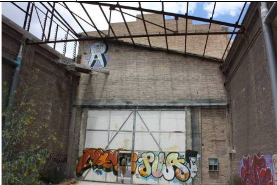
Vista interior de antiguo patio cubierto, ya no existe cubierta.
