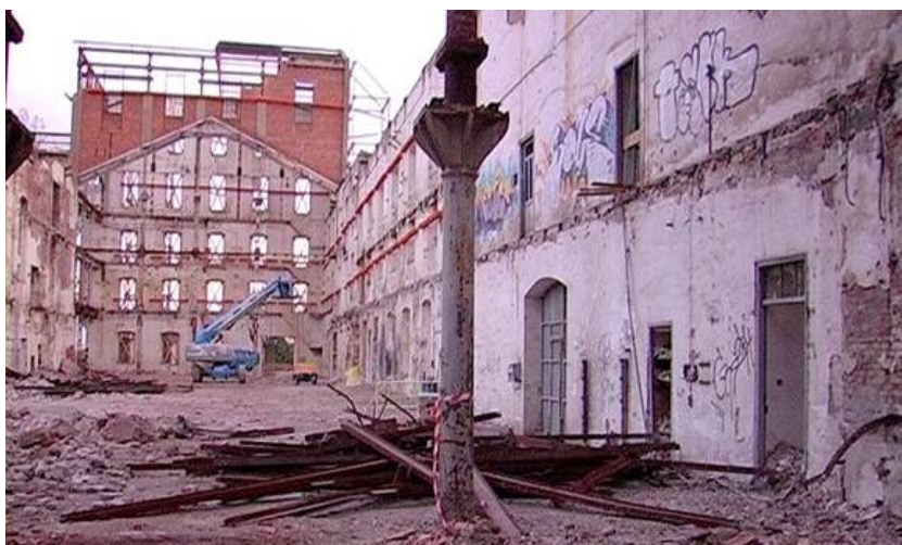
Ilustración 7.42. Estado de ruina en interior de conjunto. 327
