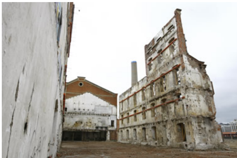
Ilustración 3.31. Azucarera Santa Elvira (León) apuntalada antes de su rehabilitación, enero 2011. 191
