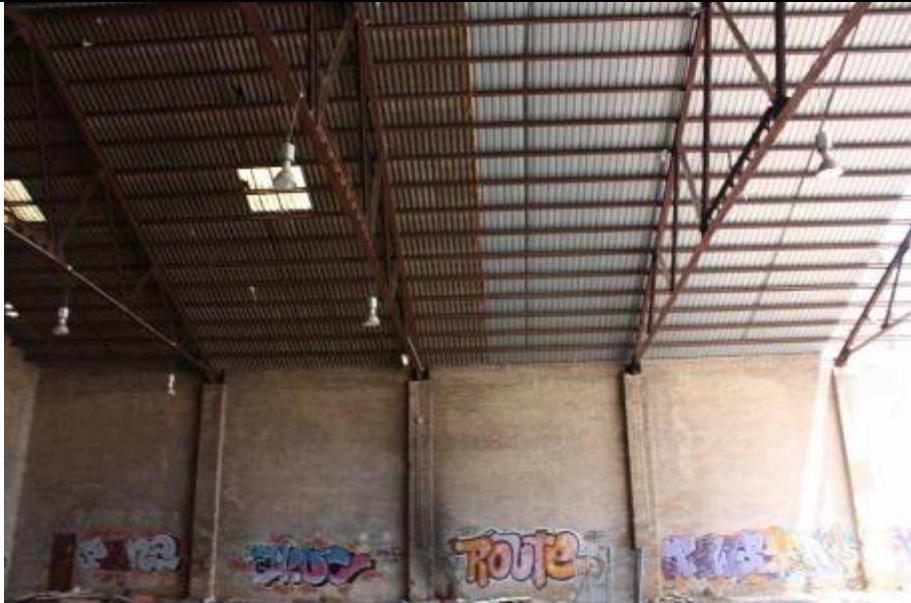
Lateral interior de nave izquierda. Se puede apreciar el estado de los muros debido a los actos vandálicos.
