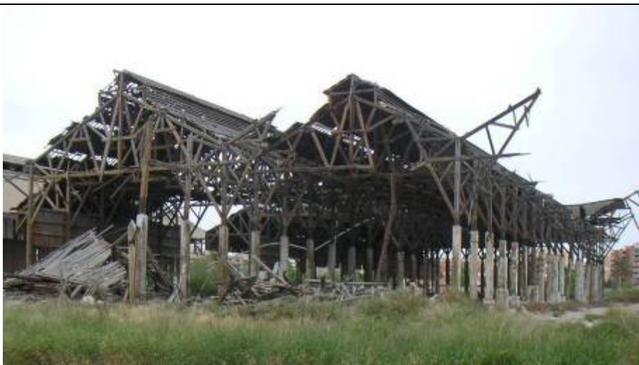
Estado de nave de mayor tamaño, con la práctica desaparición de la nave de la derecha. Además se aprecia el encamisado de hormigón de los pilares.
