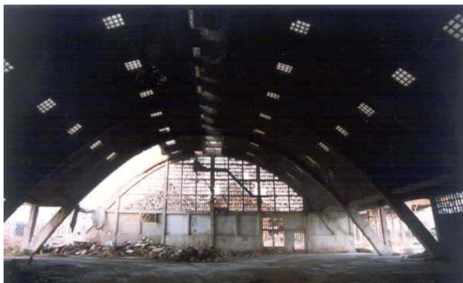
Ilustración 10.87. Interior de la nave de hormigón abandonada. 461
