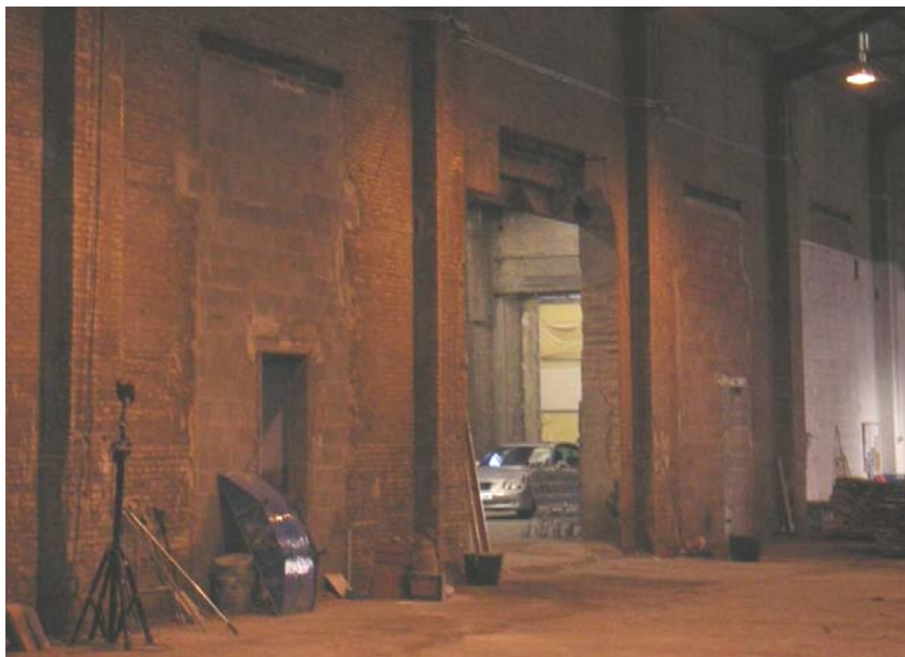
Ilustración 10.43. Estado del interior de las naves (Diana Sánchez, 2007).
