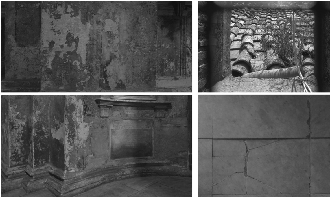
Figura 8. Fotografías del estado actual: deterioros en zócalo interior, cubierta y pavimento.
