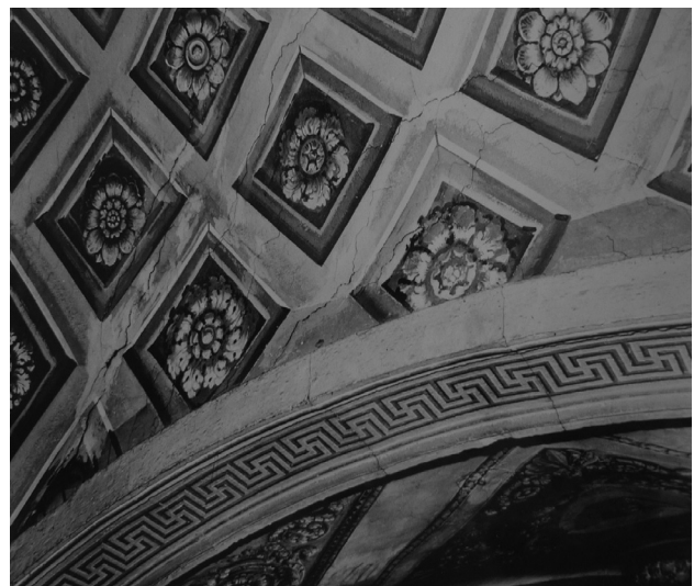
Figura 5. Fotografía de las grietas de la cúpula en 1982.
