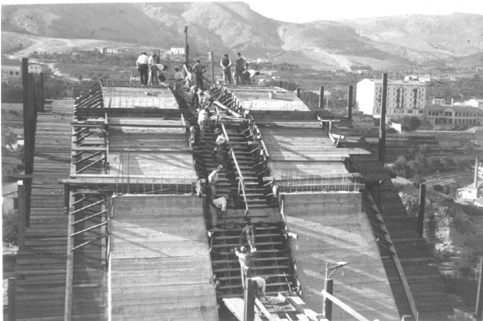
Fig. 202 Puente de San Jorge en construcción. Alcoy Vista del encofrado de las bóvedas y los arcos hormigonados. (JN)
