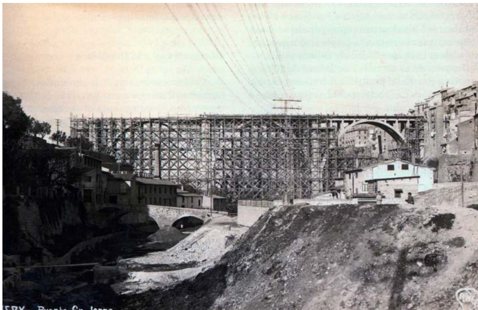
Fig. 215 Puente de San Jorge en construcción. Alcoy Comienzo del desmantelamiento de la cimbra desde aguas arriba (JN)
