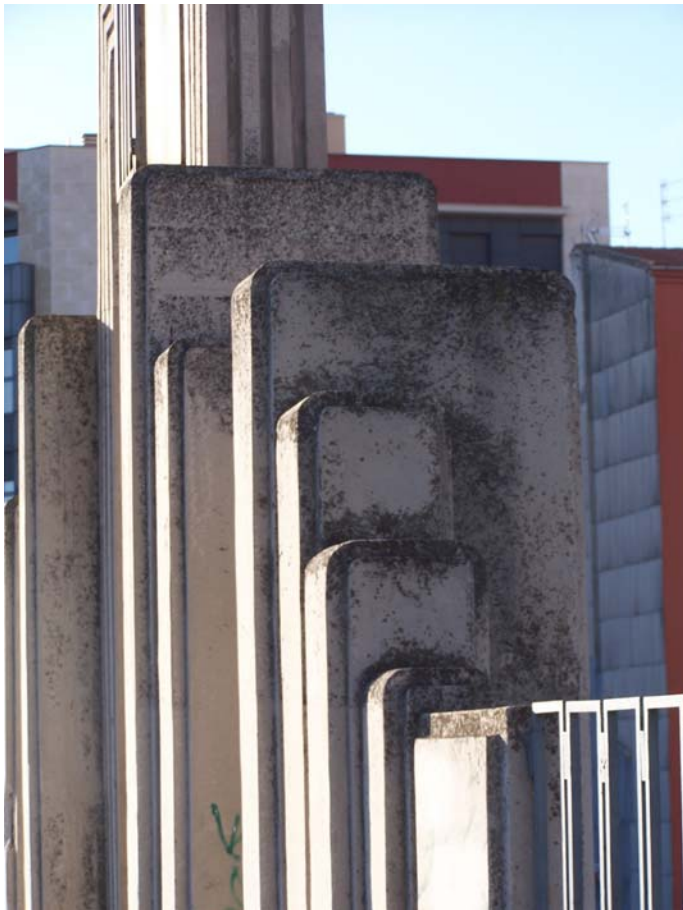
Fig.338 A pesar de todo, muchos de los elementos del Puente mantienen una muy buena calidad en sus acabados. (JFPS 2012)
