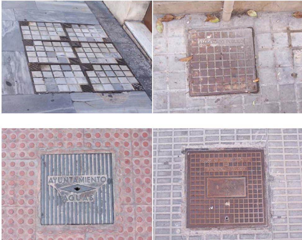
Fig. 648, 649, 650 y 651 Vista de algunas tapas de registro de distintas instalaciones (JFPS 2010)
