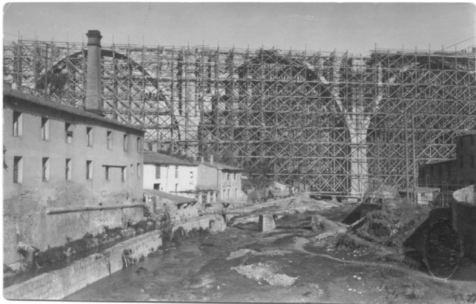
Fig. 208 Puente de San Jorge en construcción. Alcoy Vista de la cimbra llegando al nivel del tablero encofrado de las bóvedas y los arcos hormigonados. (AMA)
