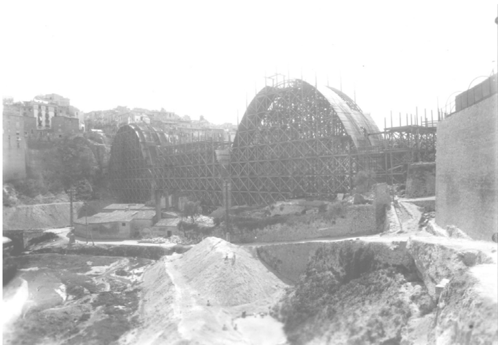
Fig. 194 Puente de San Jorge en construcción. Alcoy Vista de la construcción de la cimbra desde aguas abajo. (JN)
