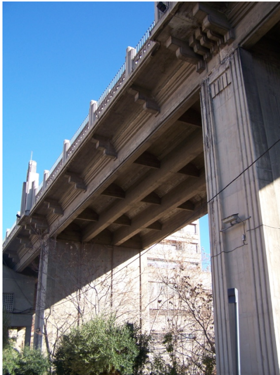
Fig. 350 Visión de la parte inferior del tablero en la zona apilastrada (JFPS 2012)
