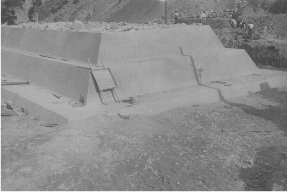
Fig. 189 Puente de San Jorge en construcción. Alcoy Vista de la cimentación de la primera pila del puente (JN)
