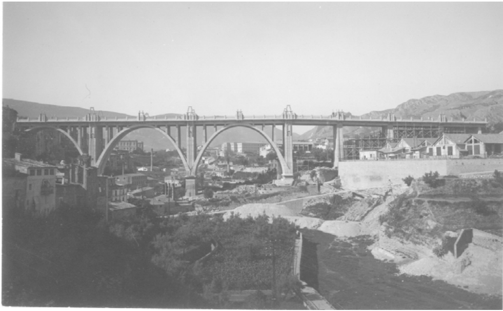
Fig. 222 Puente de San Jorge en construcción. Alcoy Vista del puente con la cimbra prácticamente desmontada desde aguas abajo. (JN)
