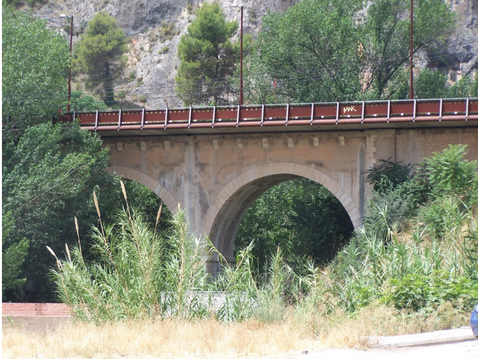
Fig. 148 Viaducto de la Uxola en el trazado del ferrocarril Alcoy-Alicante. 1926-1931. Vista desde aguas abajo. (RPM 2012)
