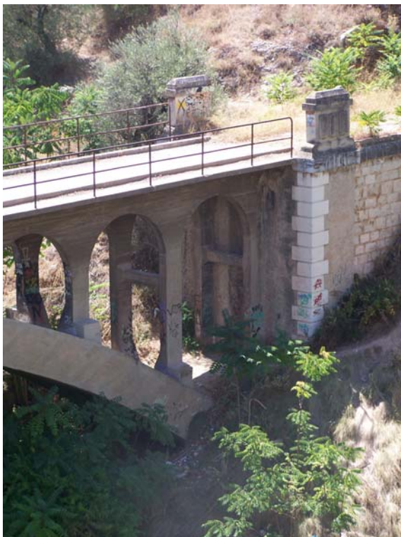
Fig. 147 Viaducto del Cint en el trazado del ferrocarril Alcoy-Alicante. 1926-1931. Detalle de la zona del estribo derecho. (JFPS 2011)
