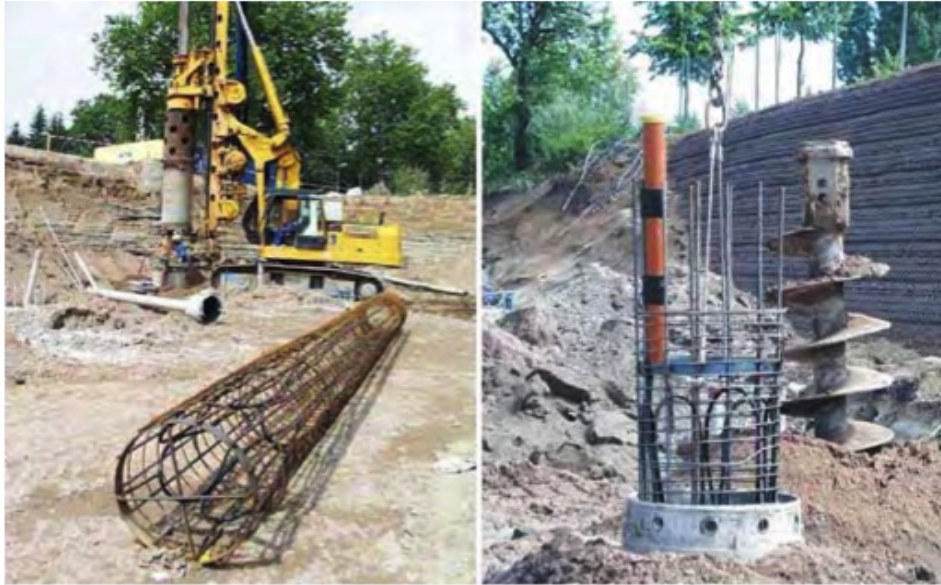
Figura 1.6: Armadura de pilote con el circuito de intercambio de calor, antes y después de su colocación en el interior de un pilote in situ
