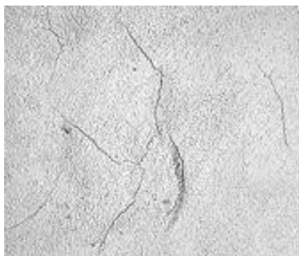
Figura 3.5. Fisuración por Retracción Plástica
