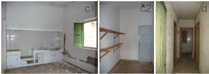
Figura nº 098. Fotografías del interior del bloque lineal de viviendas para obreros de la colonia Lucas Urquijo. 1.cocina, 2.lacena, 3.acceso distribuidor (fuente: de la autora, 2010)
