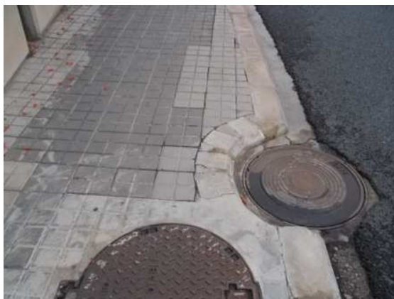
Discontinuidad en la acera por tapas de arquetas
