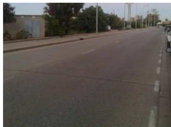
Señalización de los carriles muy borrada
