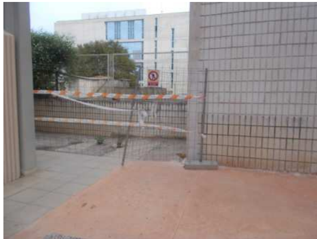
Tramo edificios 4L-4I y 4Q – detrás de la Biblioteca General: Furgoneta y motos mal aparcadas sobre zona peatonal. Se interrumpe por obras la continuidad peatonal (al este del edificio Biblioteca)
