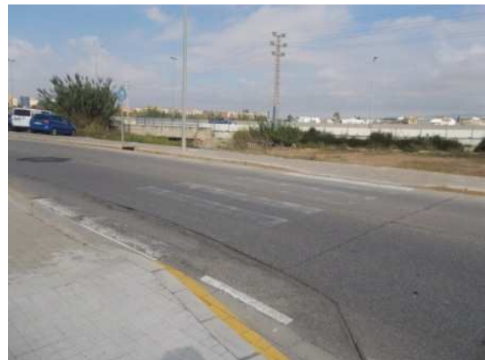
Vista de tramo entre acceso B y C. Señalización de paso de peatones muy borrada
