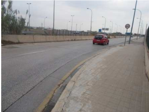
No se señalizan los sentidos de circulación
