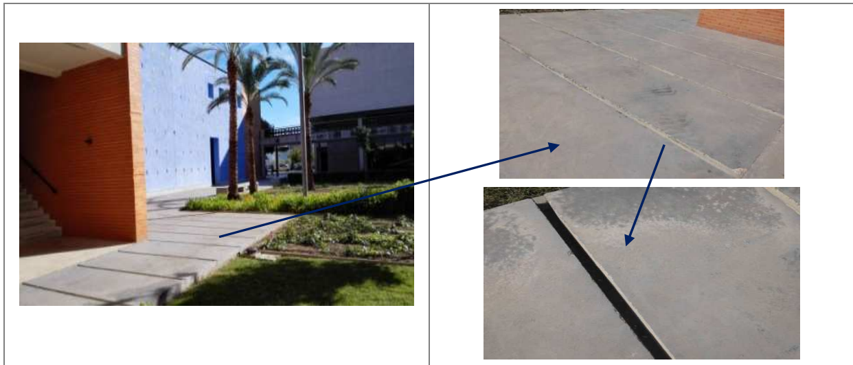
Tramo acera oeste: anchura suficiente pero pavimento irregular (losetas de hormigón)
