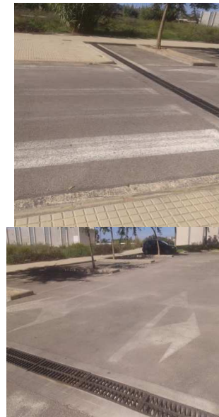
Pintura de señalización bastante borrada
