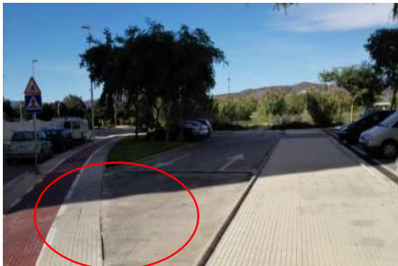
Punto de entrada y salida señalizado pero no hay señal identificativa del parking; La acera de la calle exterior no dispone de paso de peatones en este punto de acceso.
