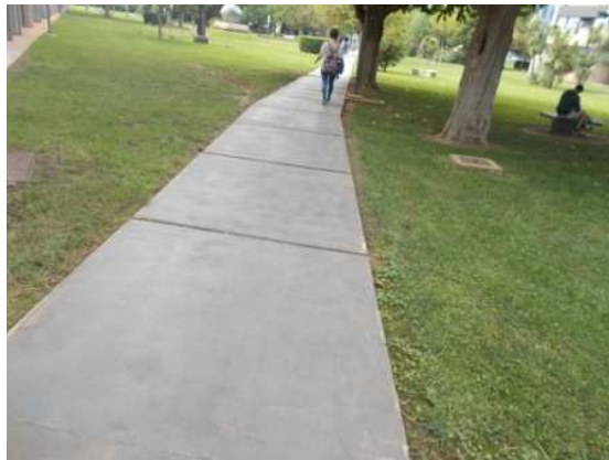
Caminos pavimentados en zona C/ Federico Mayor Zaragoza: Anchura suficiente libre de obstáculos
