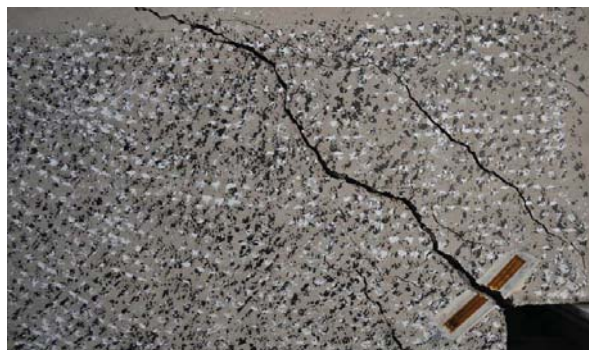
DETALLE DE FISURACIÓN A LA CARGA MÁXIMA
