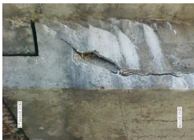
Fotografía II.1: Imagen de la fisuración en el paso superior Concorde tomada durante una inspección 30 minutos antes del colapso de la estructura [3]
