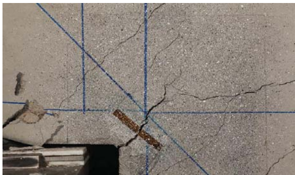
FISURACIÓN DEL APOYO A LA CARGA MÁXIMA
