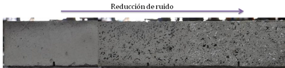
Fotografía F.1: Distintos patrones de textura superficial
