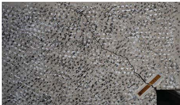
DETALLE DE FISURACIÓN AL 80% DE LA CARGA MÁXIMA
