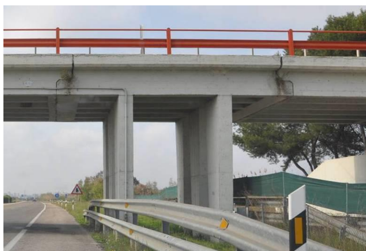
Fotografía I.1: Apoyos a media madera en paso superior de carretera CV-500 en el Saler, Valencia
