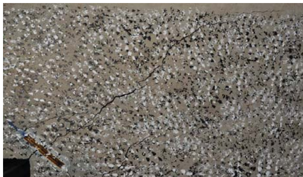
DETALLE DE FISURACIÓN A LA CARGA MÁXIMA
