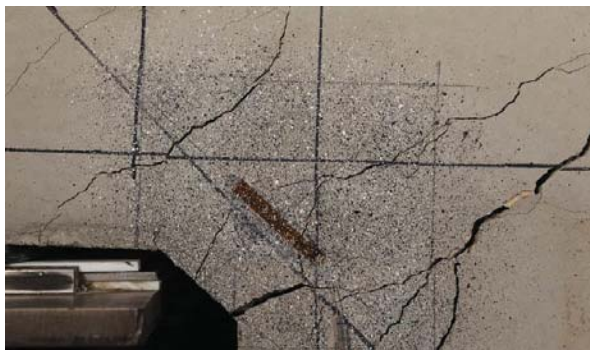
DETALLE DE FISURACIÓN A LA CARGA MÁXIMA
