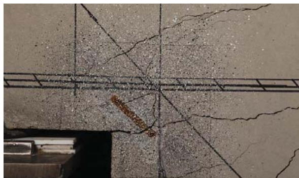
DETALLE DE LA ZONA DE FISURACIÓN A LA CARGA MÁXIMA
