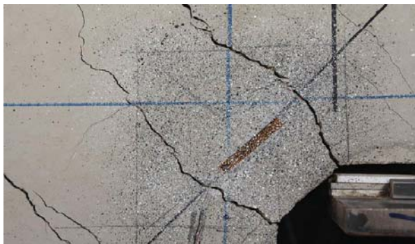
DETALLE DE FISURACIÓN A LA CARGA MÁXIMA
