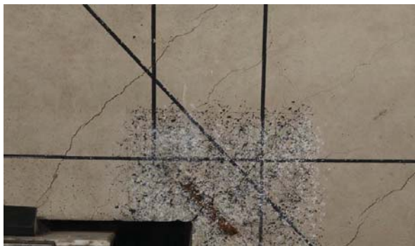
FISURACIÓN DEL APOYO A LA CARGA ÚLTIMA
