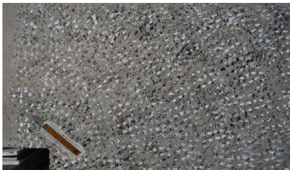
DETALLE DE FISURACIÓN EN SERVICIO
