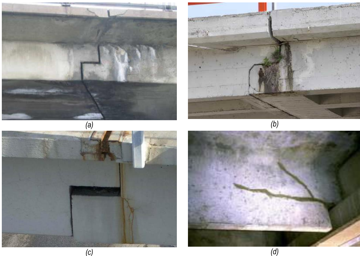
Fotografía I.2: Ejemplos de AMM con problemas de durabilidad: (a) Concorde overpass durante una inspección especial en 2004, dos años antes de su colapso [3]; (b) paso superior en carretera CV-500 cerca de Valencia (foto propia); (c) AMM en puente peatonal [4]; (d) fisuras en estructura de aparcamiento en Pittsburg, USA [5].
