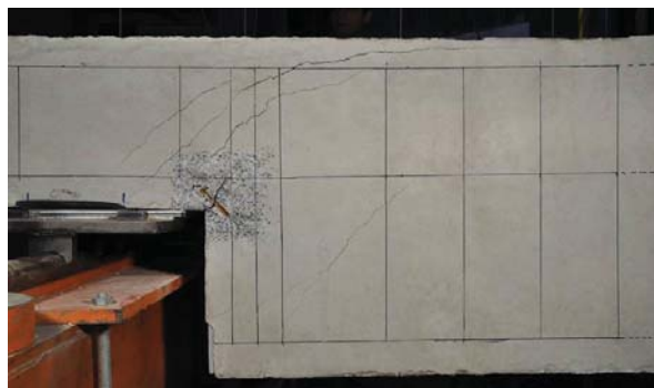
VISTA GENERAL DEL APOYO TRAS LA ROTURA
