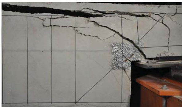
VISTA GENERAL DE LA PIEZA TRAS LA ROTURA
