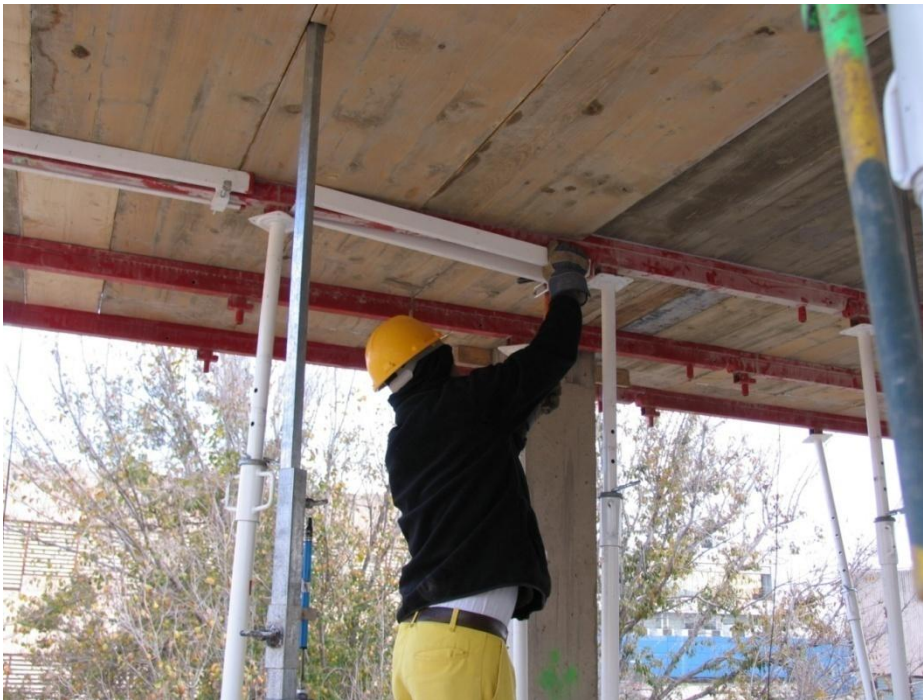
Fig. II.31 Manipulación del basculante de las sopandas principales durante la operación de clareado
