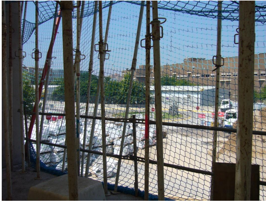
Fig. II.55 Elementos de seguridad del forjado 3
