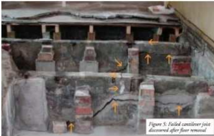
Imagen 46: Estado del voladizo cuando se retiró el suelo
