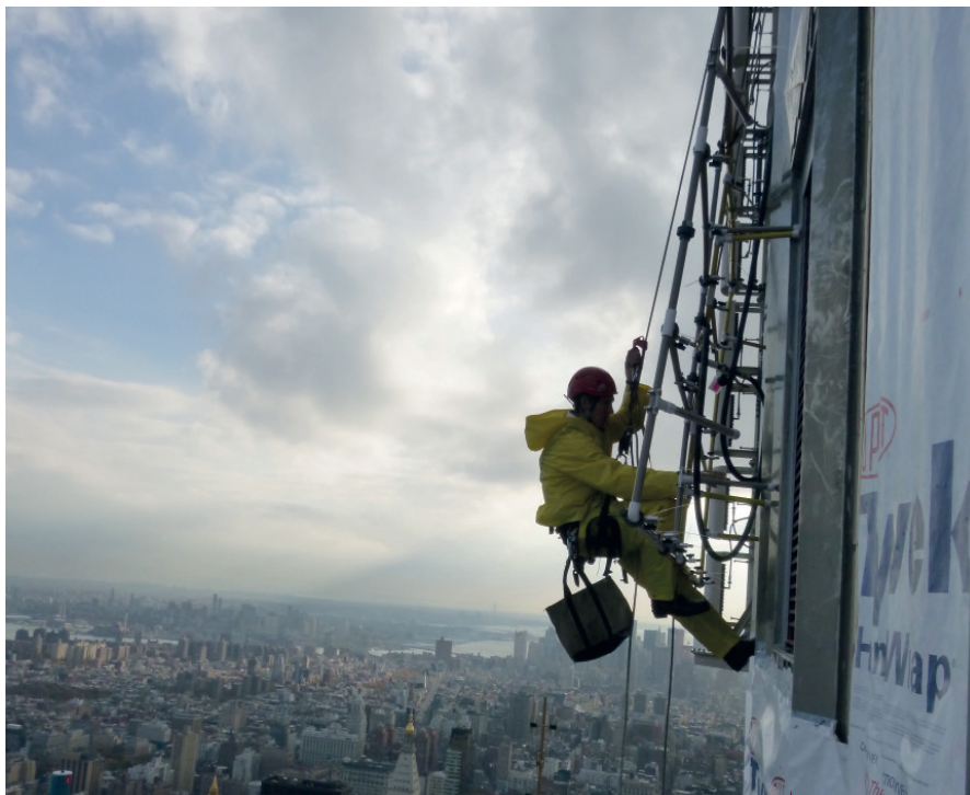
Pulverización de agua para evidenciar filtraciones en el Empire State de Nueva York (Vertical Access) Water spraying test for evidence infiltrations in the Empire State of New York (Vertical Access)
