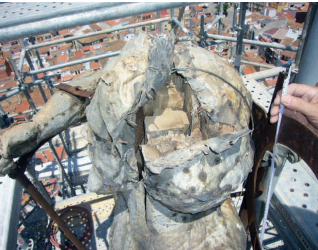
19. Inspección de la madera de la cabeza de la escultura de San Juan
