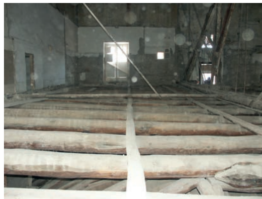
11. El elemento horizontal en el fondo brinda una idea de la deformación del conjunto de jácenas en primer plano.
